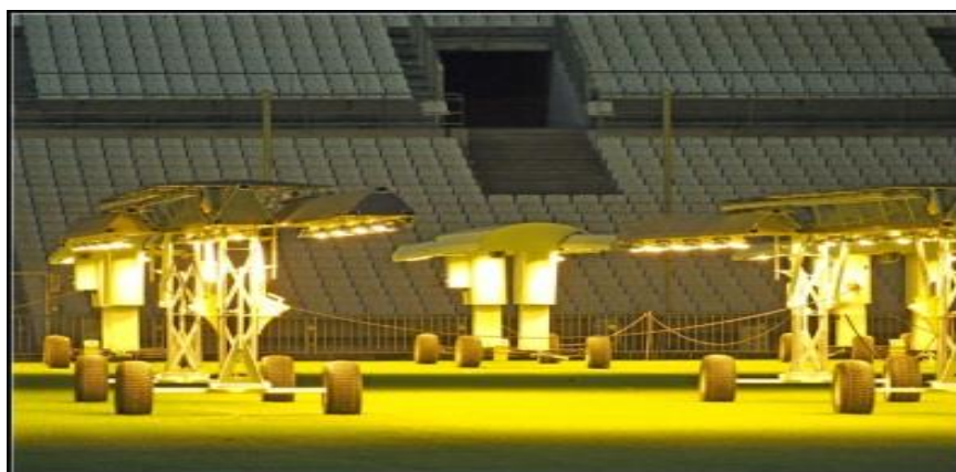
Figure 104 : rampes d'éclairages horticoles
