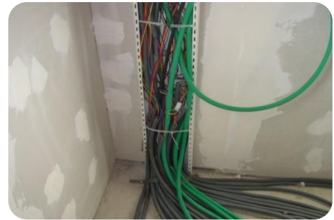
Fig246. Les gaines techniques
