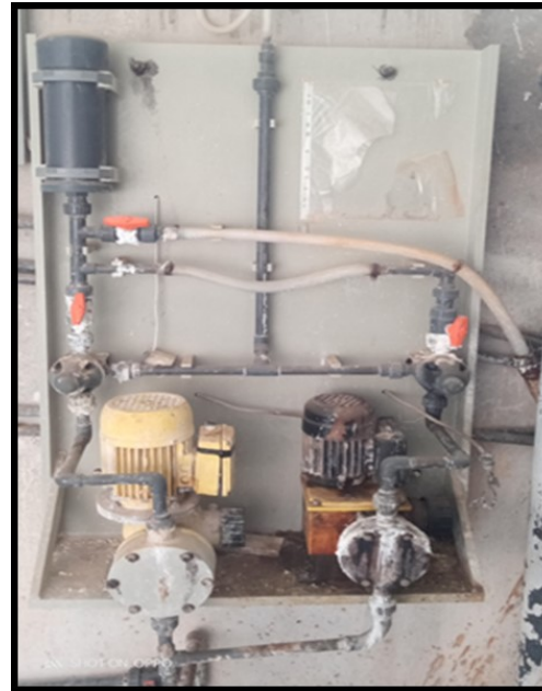
Figure 16 : Pompe pour la pré chloration
