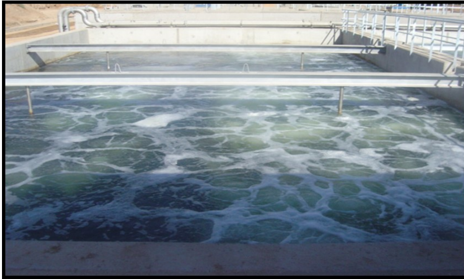
Figure 11 : Bassin de la nitrification
