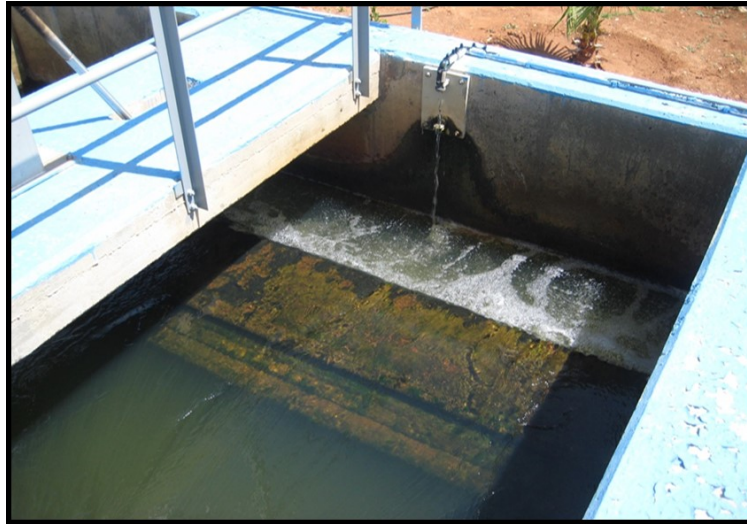
Figure 8 : Bassin de coagulation
