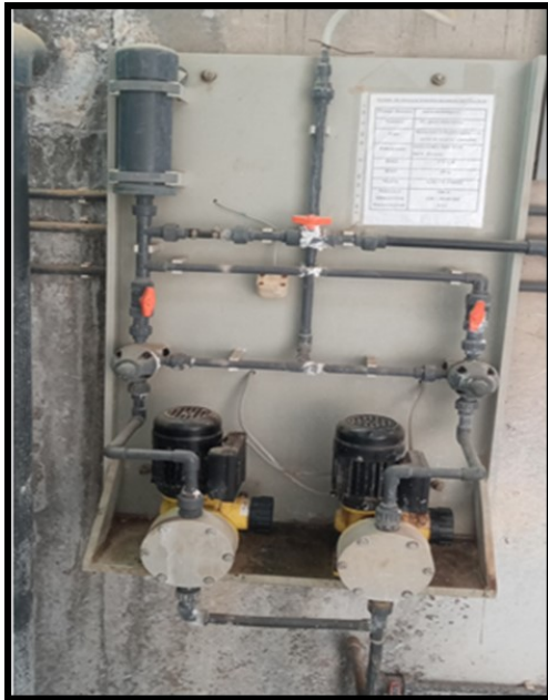
Figure 15 : Pompe pour la chloration
