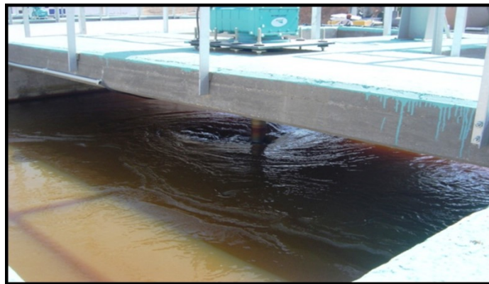
Figure 9 : Bassin de flocculation
