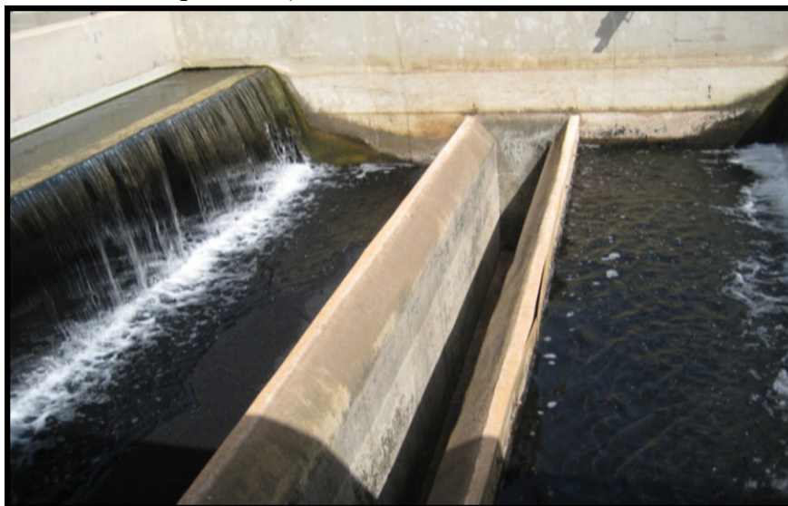
Figure 14 : Bassin de charbon actif
