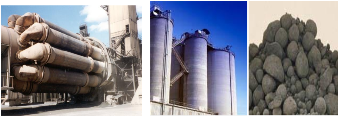
Figure 2.15 : Refroidissement et stockage de clinker.
