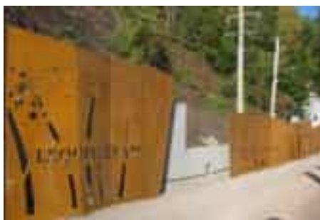
Figure 139 : Mur de consolidation de la falaise (Source : https://www.capitale.gouv.qc.ca )
