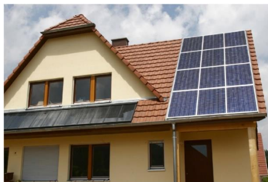
Figure II. 41 : Capteurs solaires thermiques intégrés au toit.
