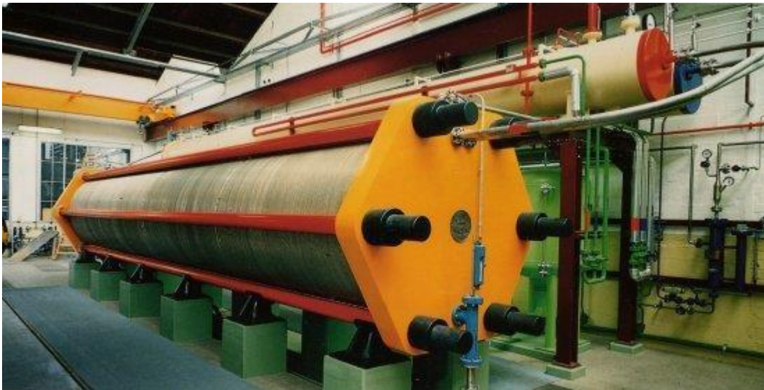
Figure 3.22. Electrolyseur alcalin ELT type S 556, 760 Nm 3 /h – 30 bars
