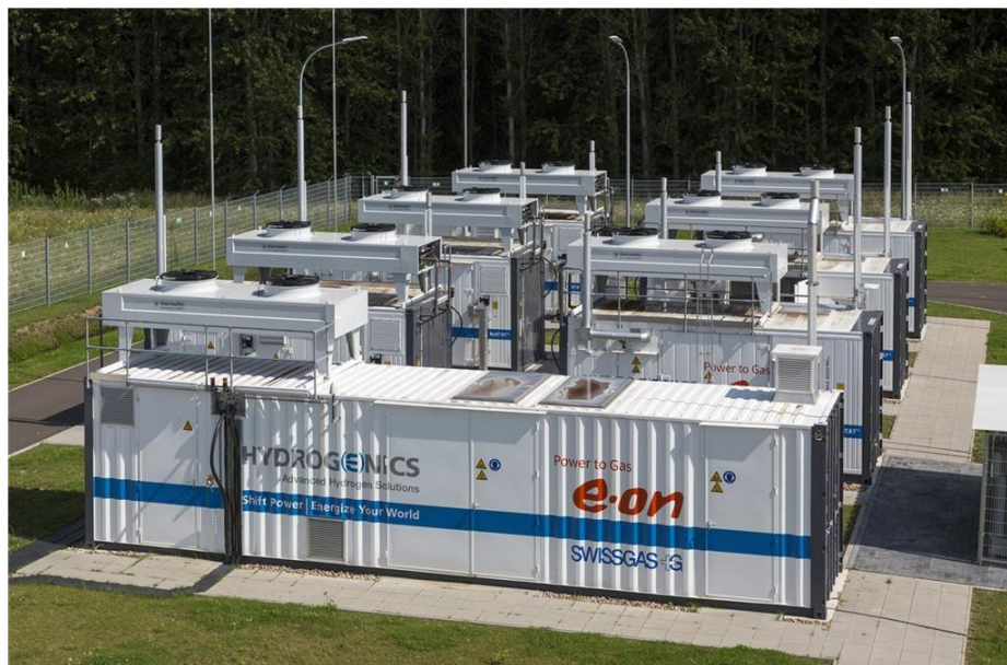
Figure 3.26. Le système Hydrogenics/StratosFuel de 2,5 MWe (2016)
