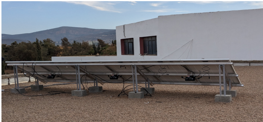
FIGURE II.6 – Panneaux photovoltaïques + micro onduleur
