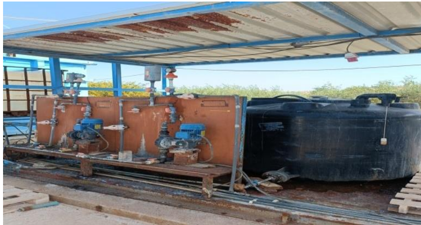
Photo 3: L'injection de l'hypochlorite de sodium NaClO (Tlemcen le 09-04-2025)
