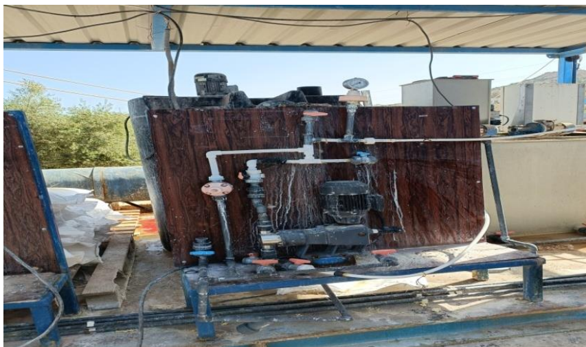
Photo 4: L'injection de coagulant sulfate d'alumine (Tlemcen le 09-04-2025)
