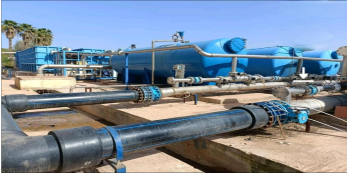
Photo 7: Trois filtres de filtration d'une seule filière
