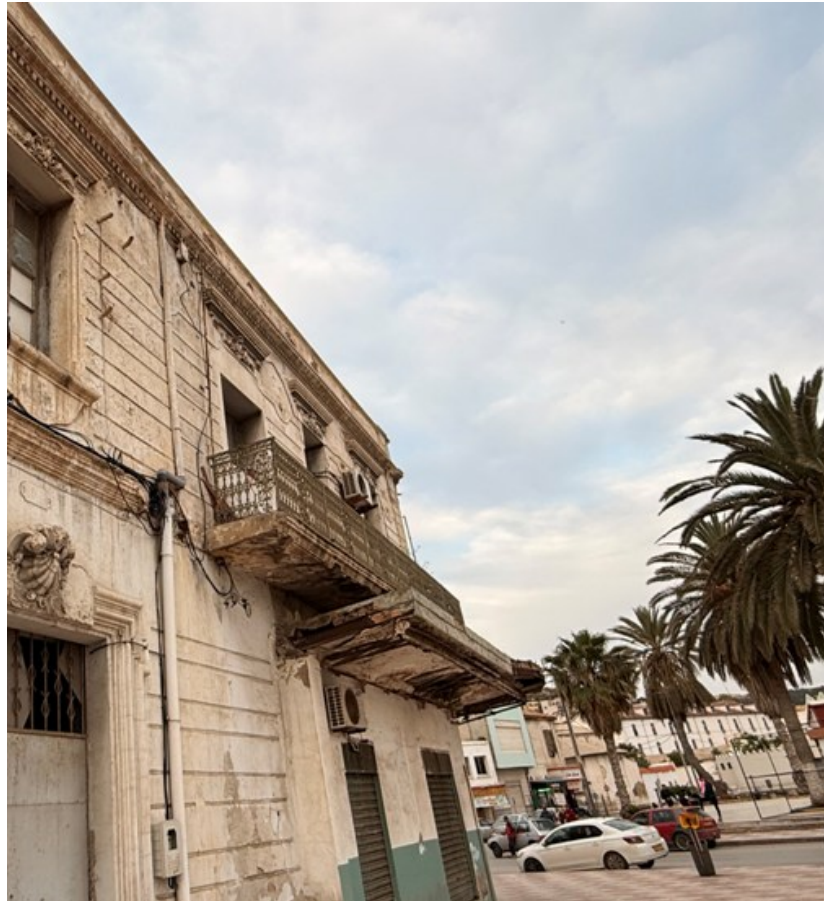
Figure IV.7. Vue d'ensemble de la façade urbaine présentant une dégradation avancée des éléments architecturaux en encorbellement et des risques de chute de matériaux
