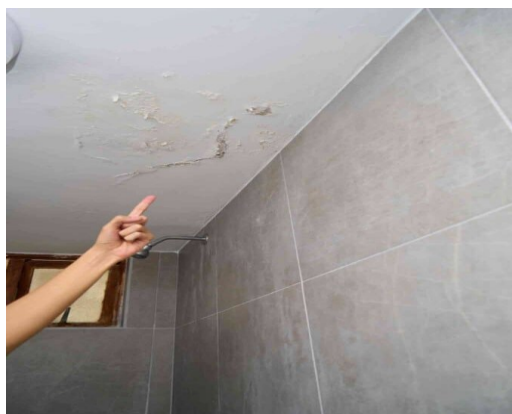
Figures I.9. Exemple d'infiltrations
