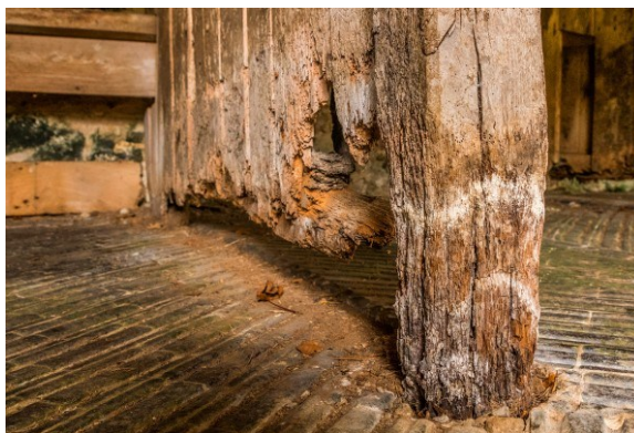
Figures I.11. Exemple de dégradations biologiques
