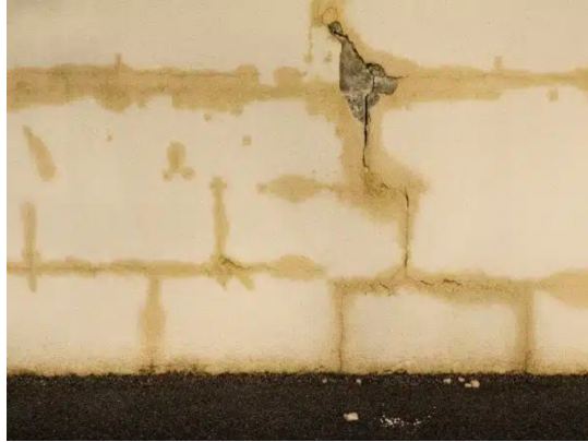
Figures I.8. Exemple de remontées capillaires
