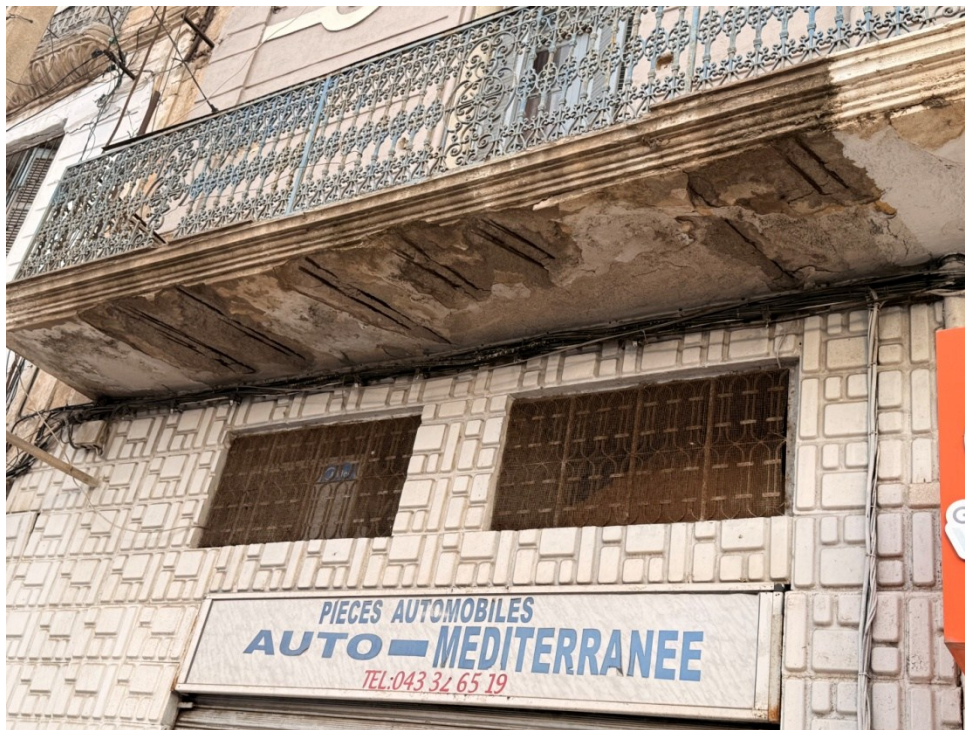
Figure IV.3. Éclatement total du béton d'enrobage en sous-face de balcon avec mise à nu et perte de section critique des armatures d'acier fortement corrodées
