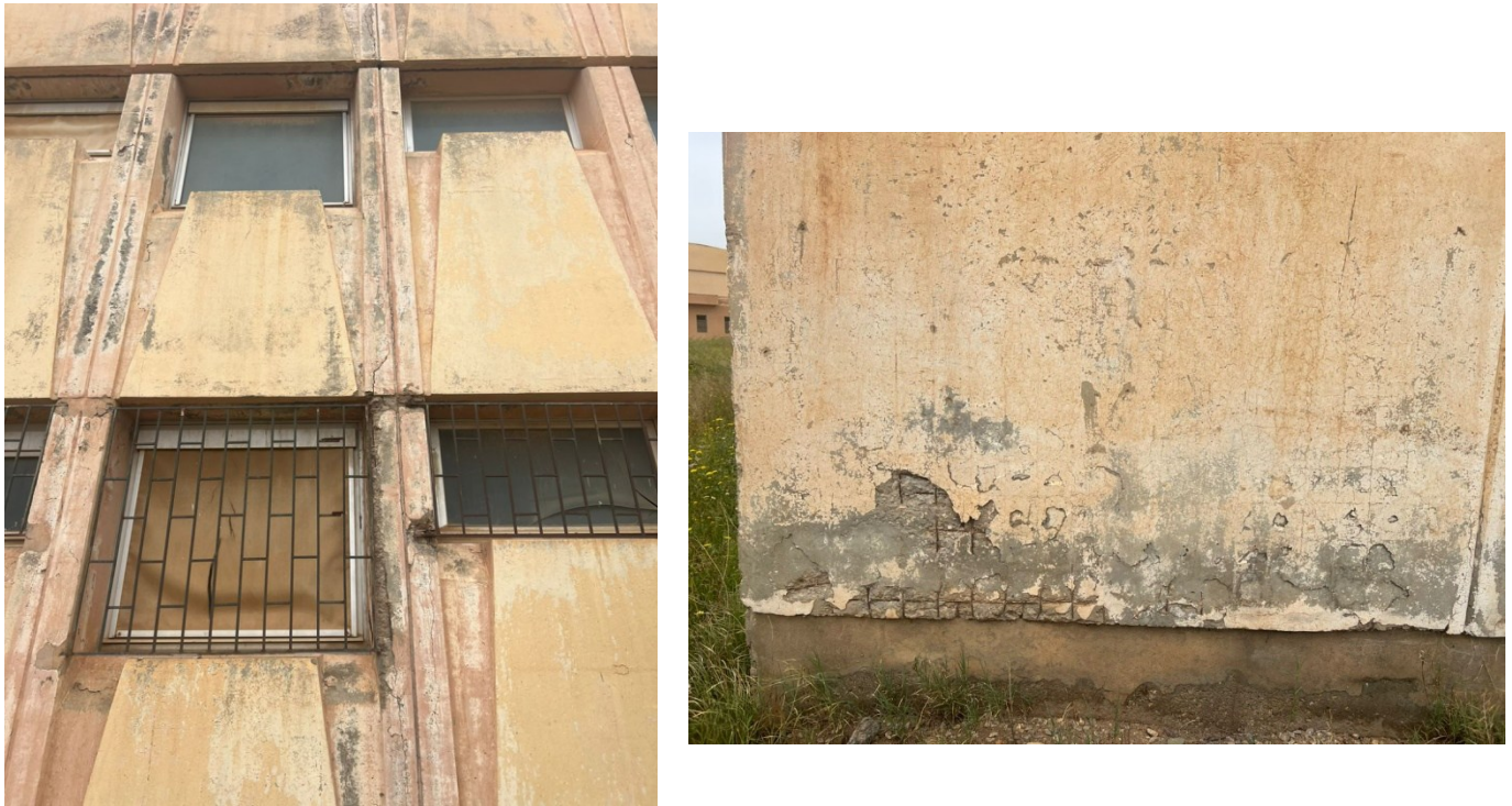
Figure IV.10. Écaillage prononcé de l'enduit en base de façade extérieure
