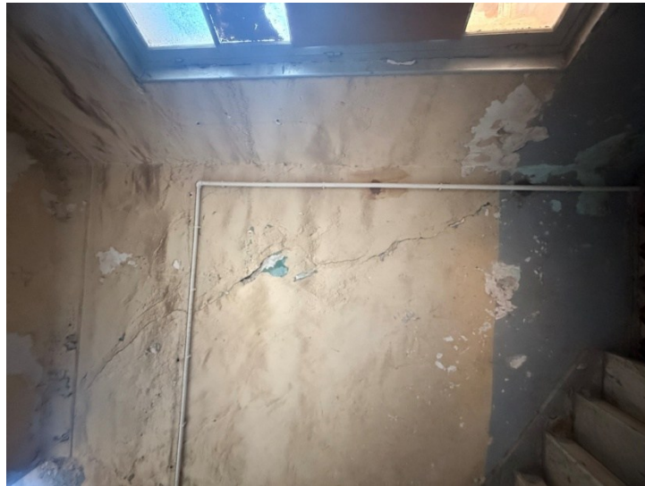
Figure IV.5. Fissure oblique et traversante sur mur de maçonnerie porteur, caractéristique d'un phénomène de tassement différentiel de l'infrastructure.
