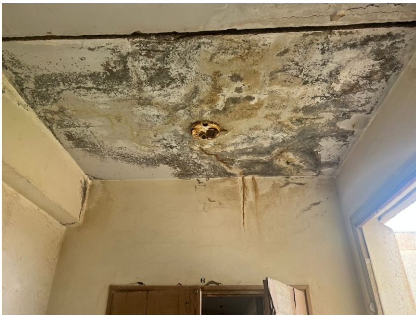
Figure IV.11. Plafond de couloir intérieur - moisissures et infiltrations
