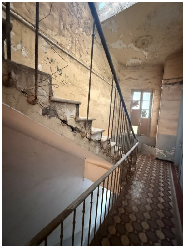
Figure IV.6. Fissuration longitudinale majeure et ramifiée au niveau de la paillasse de l'escalier, indiquant un cisaillement structurel et une perte de capacité portante locale
