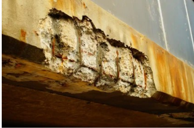
Figures I.12. Exemple de corrosion des éléments métalliques
