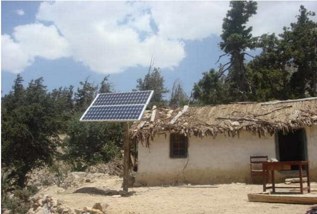
Figure 1.3 : Électrification des villages isolés par des systèmes photovoltaïques (IUCN, 2010).
