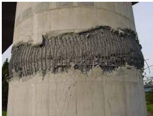
Figure I-2 : Flambement d'une pile de pont lors du séisme [11].
