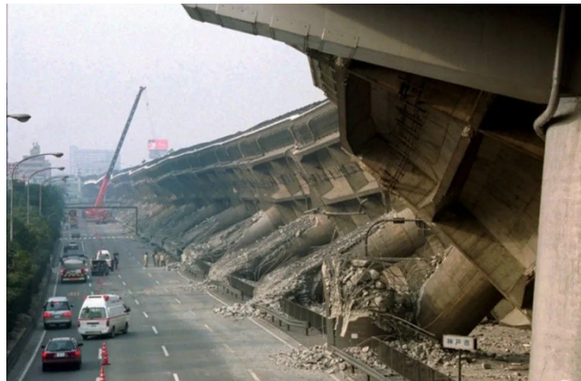
Figure I-1 : Effondrement d'un viaduc pendant le séisme de Kobe en 1995, causé par la liquéfaction du sol [2].
