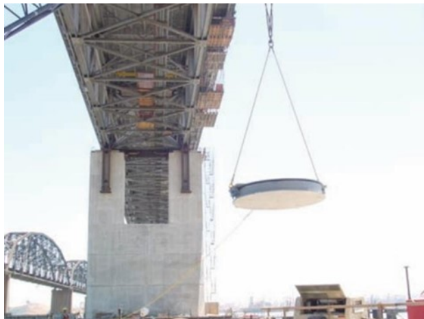
Figure I-16 : Isolateur à pendule à friction en cours d'installation sur le pont Benecia-Martinez, Californie [13].
