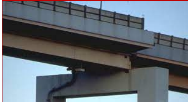
Figure I-3 : Déplacement latéral du tablier du pont et la chute des supports sur la palée d'un pilier lors du séisme de Kobe en 1995[2].
