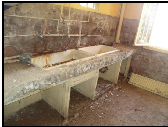
Figure 16: Installation de la plomberie en mauvais état de fonctionnement 45
