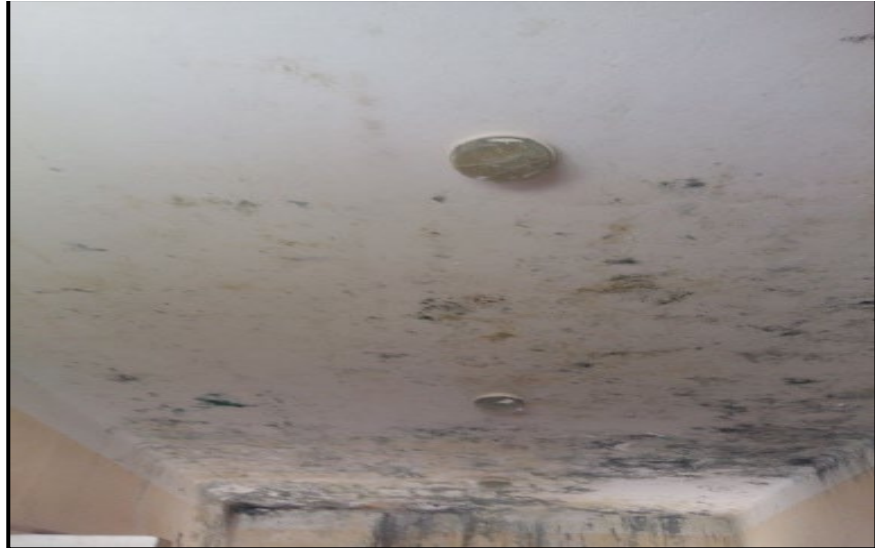
Figure 15 : l'eau infiltrée dans les planchers
