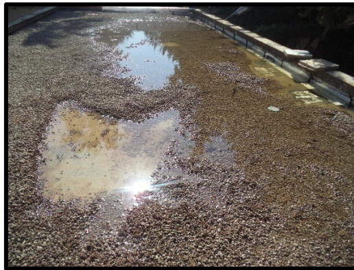
Figure 18 : L'eau infiltrée dans les planchers 46
