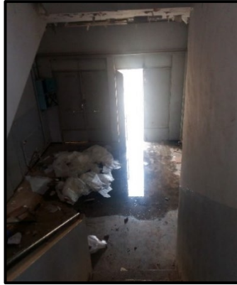
Figure 17: Bloc des labos complètement abandonner
