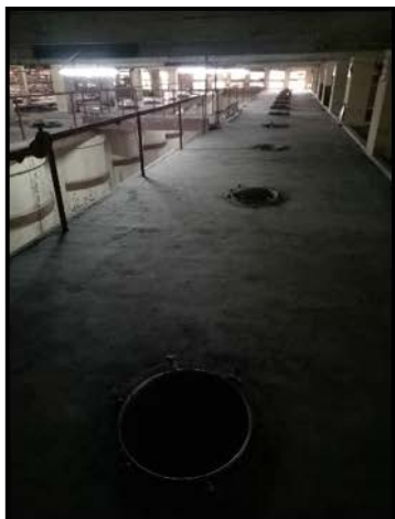
Vue sur le haut des cuves
