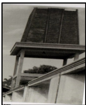
Figure 27: Réfrigérant sur le toit d'une cave 121
