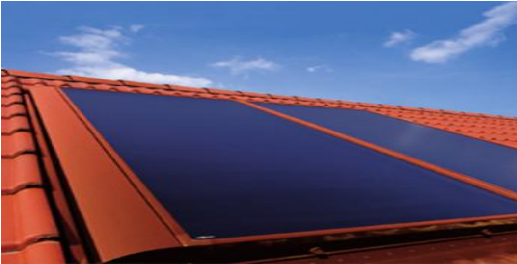
Figure II.23: Capteur plan vitré intégré à la toiture [38]
