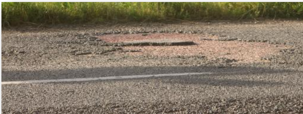
Figure 4. 1: Arrachement de la couche de roulement.
