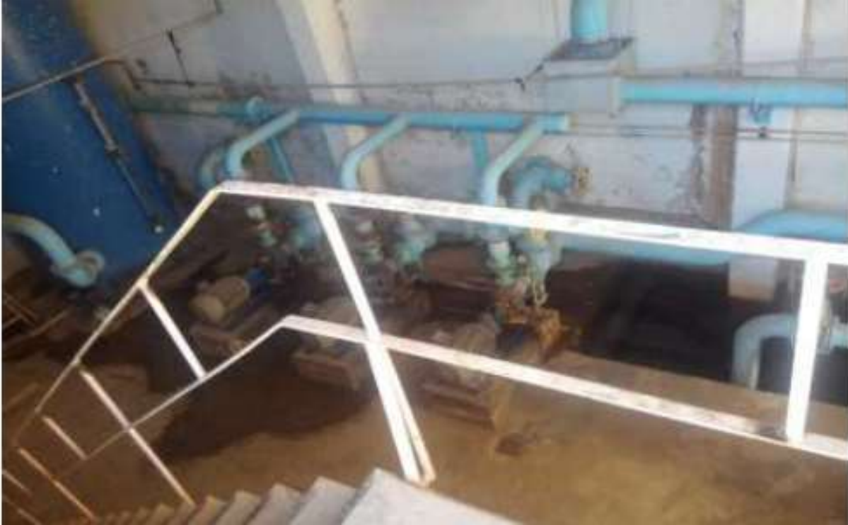
Figure III.9 : Photo de la station de recyclage de boues.
