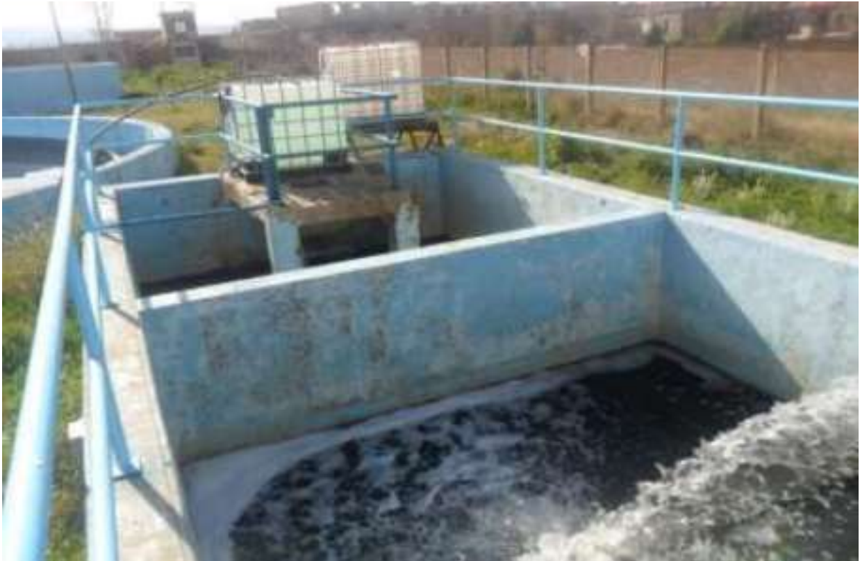
Figure III.10 : Photo du bassin de post chloration
