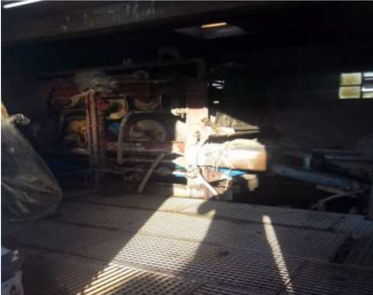
Figure III.11 : Photo de l'épaississeur des boues.
