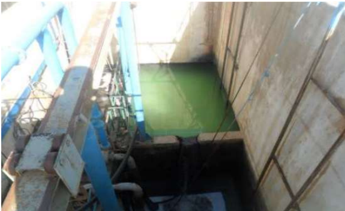
Figure III.3: Photo du bassin de collecte des eaux usées sanitaires
