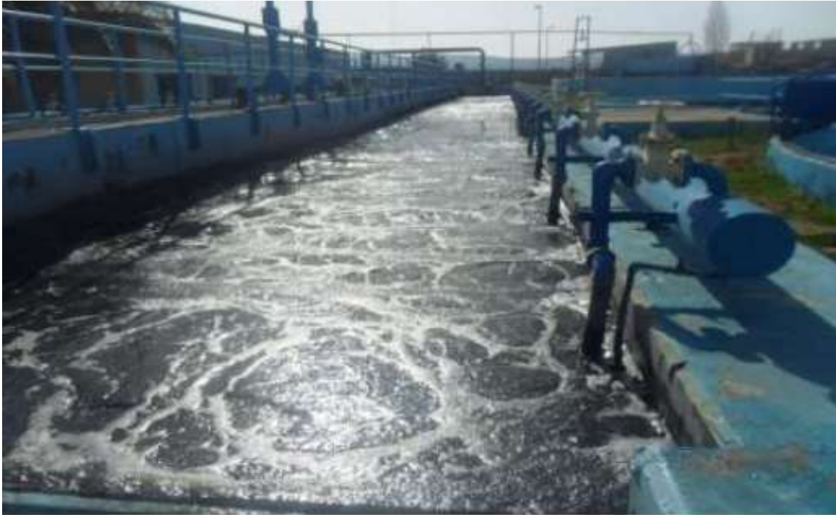
Figure III.7 : Photo du bassin biologique (bassin d'aération)
