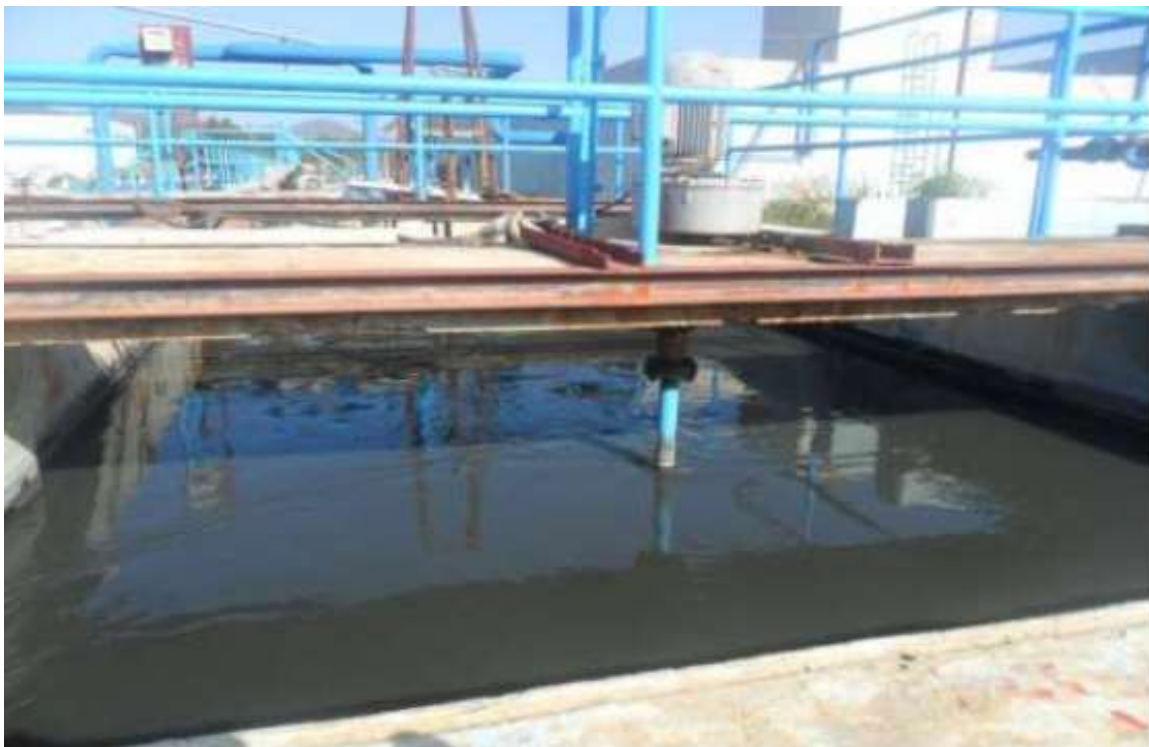
Figure III.6 : Photo du bassin de mélange et de neutralisation et d'égalisation N°2
