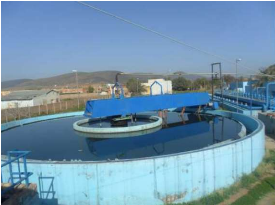
Figure III.5 : Photo du flocculateur clarificateur.
