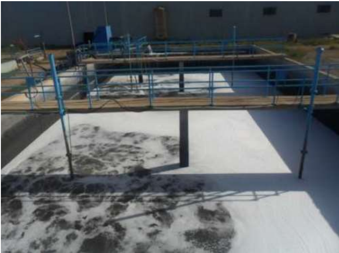
Figure III.4 : Photo du bassin de mélange et d'égalisation N°1
