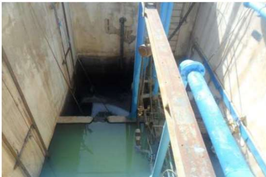
Figure III.2 : Bassin de collecte des eaux usées industrielles.
