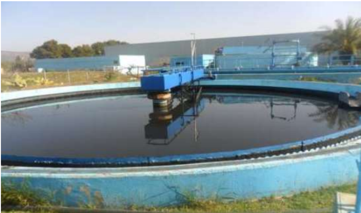
Figure III.8 : Photo du bassin de clarification finale
