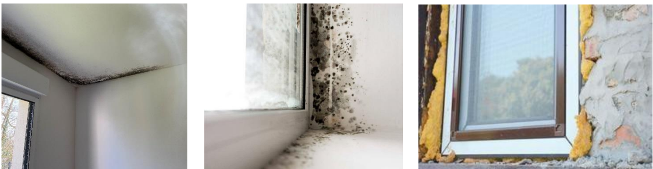
Figure I.12 Problèmes d'humidité et de condensation
