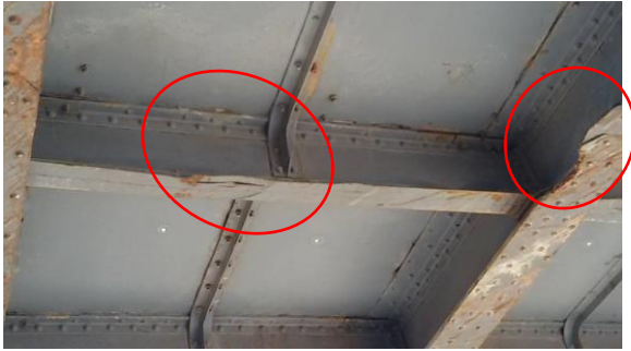
(e) Déformations plastiques concentrées
