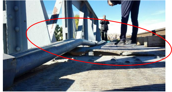
(f) Détachement du platelage
