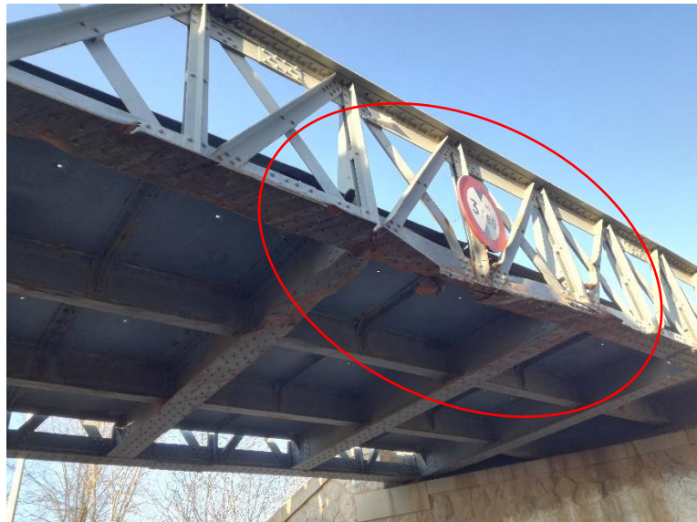
(b) Zone centrale endommagée
