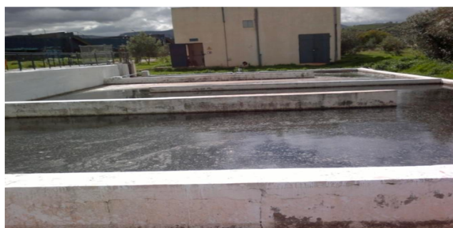
Figure 9 : Bassin de chloration
