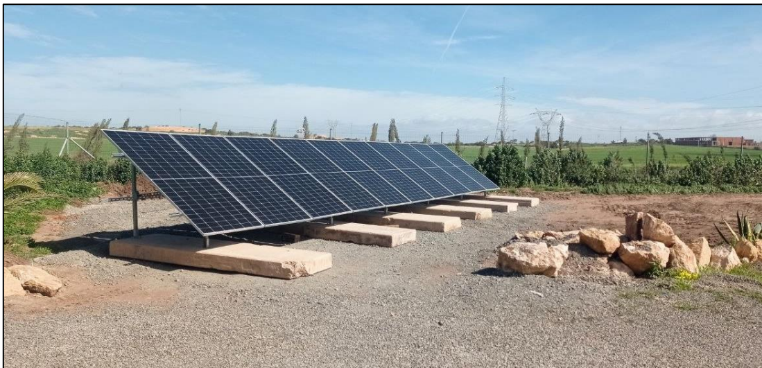
Figure 36 : panneaux solaires à la place de l'énergie classique
