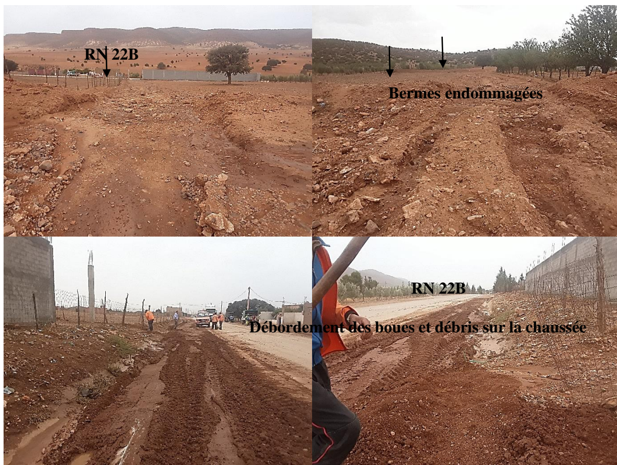
Figure 52 : Dégradation des Bermes sur le Réseau Routier : Cas de la RN 22B au PK 38+800
