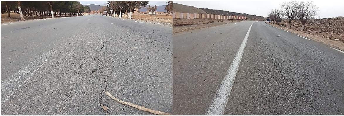
Figure 26 : Dégradations observées sur la chaussée de la RN 22.
