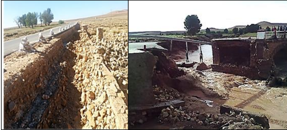
Figure 22 : Dégâts des inondations sur les infrastructures routières. Daïra de Sebdu.
