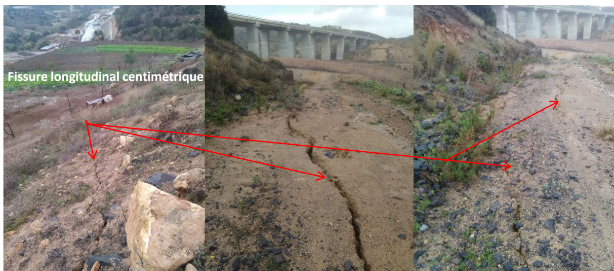
Figure 4.9: début de fissuration au niveau de tête et le long du pied de talus amont [20]
