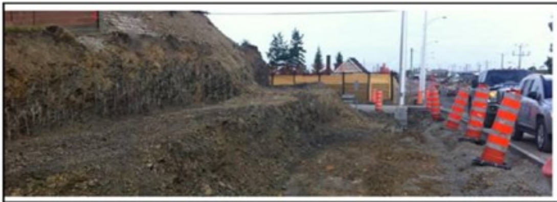
Figure 1.13: Les déblais et les excavations à la base du talus
