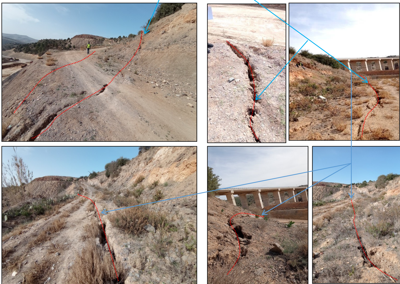
Figure 4.10: périmètre de la fissuration en 02/2022 localisé sur Google Earth [20]
