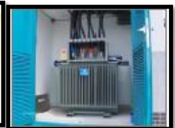
Figure 258 : Poste de transformateur
