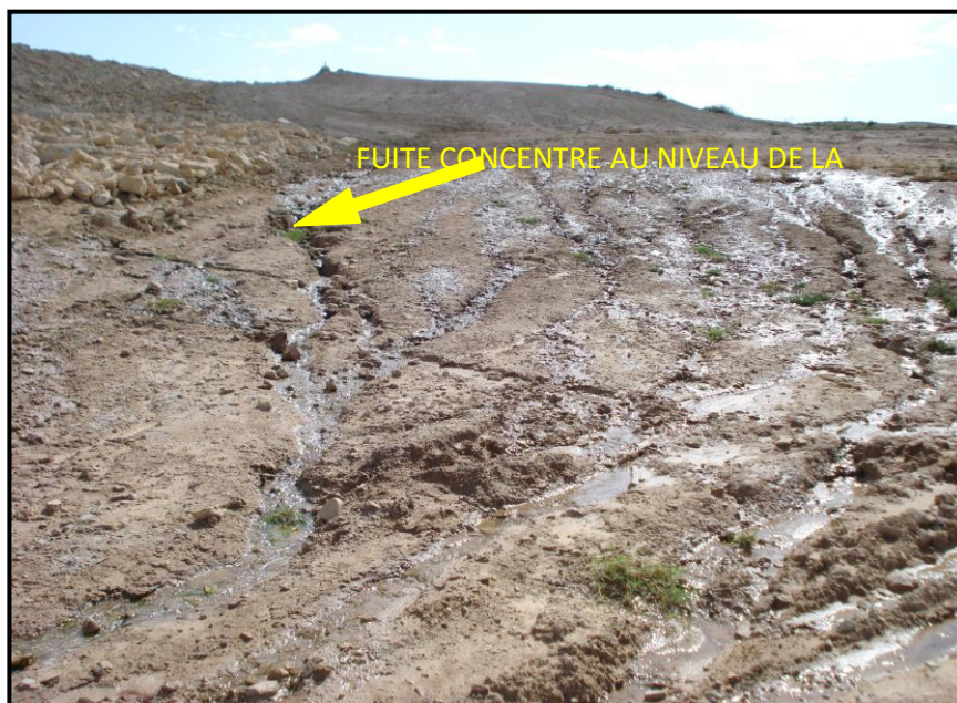
Photo 3.15 Concentration des fuites rive Gauche
