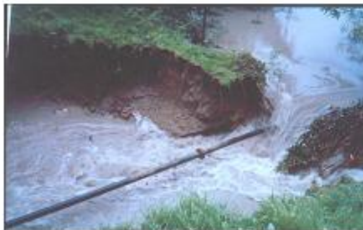
Photo 1.1 Renard autour d'une canalisation traversant la digue
