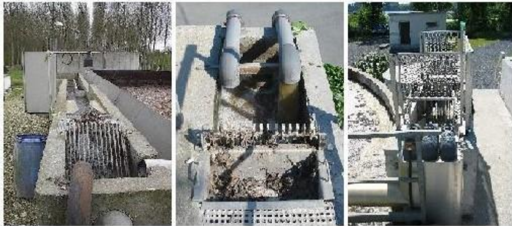
Figure (I.2) : dégrilleurs [5].
