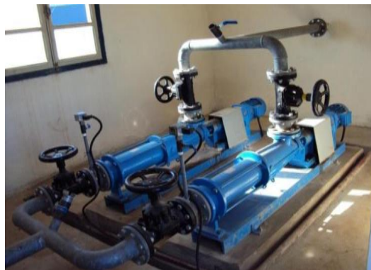
Figure III.11 : Pompe à boue.
