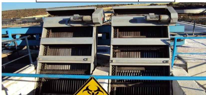
Figure III.4 : Grille mécanisée (2 unités).
