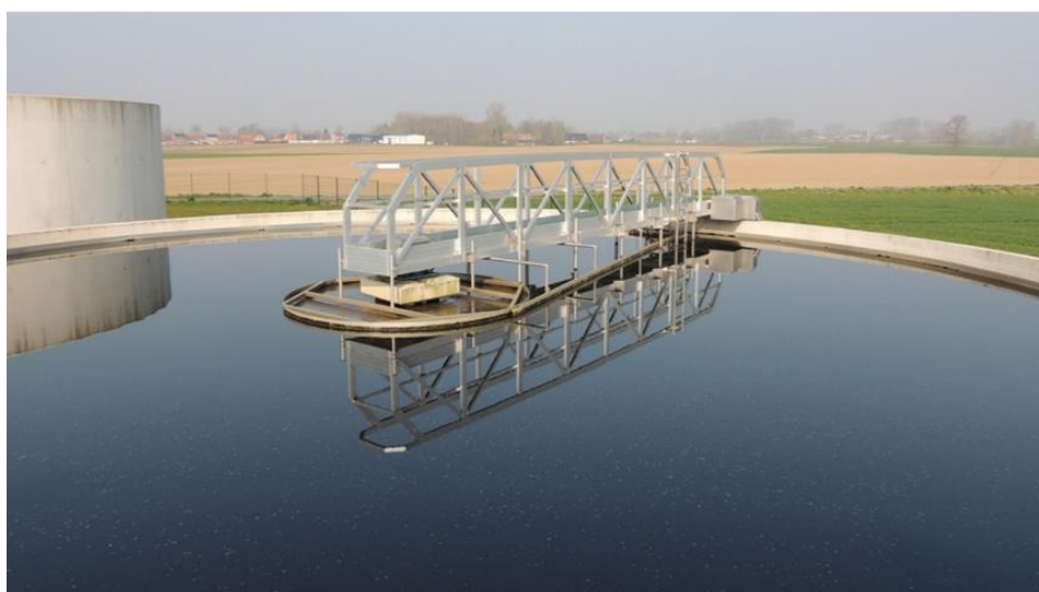
Figure (I.10) : Un clarificateur.
