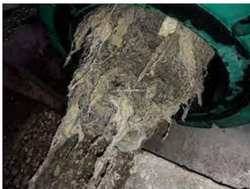
Figure (I.14) : Canalisation bouchée.
