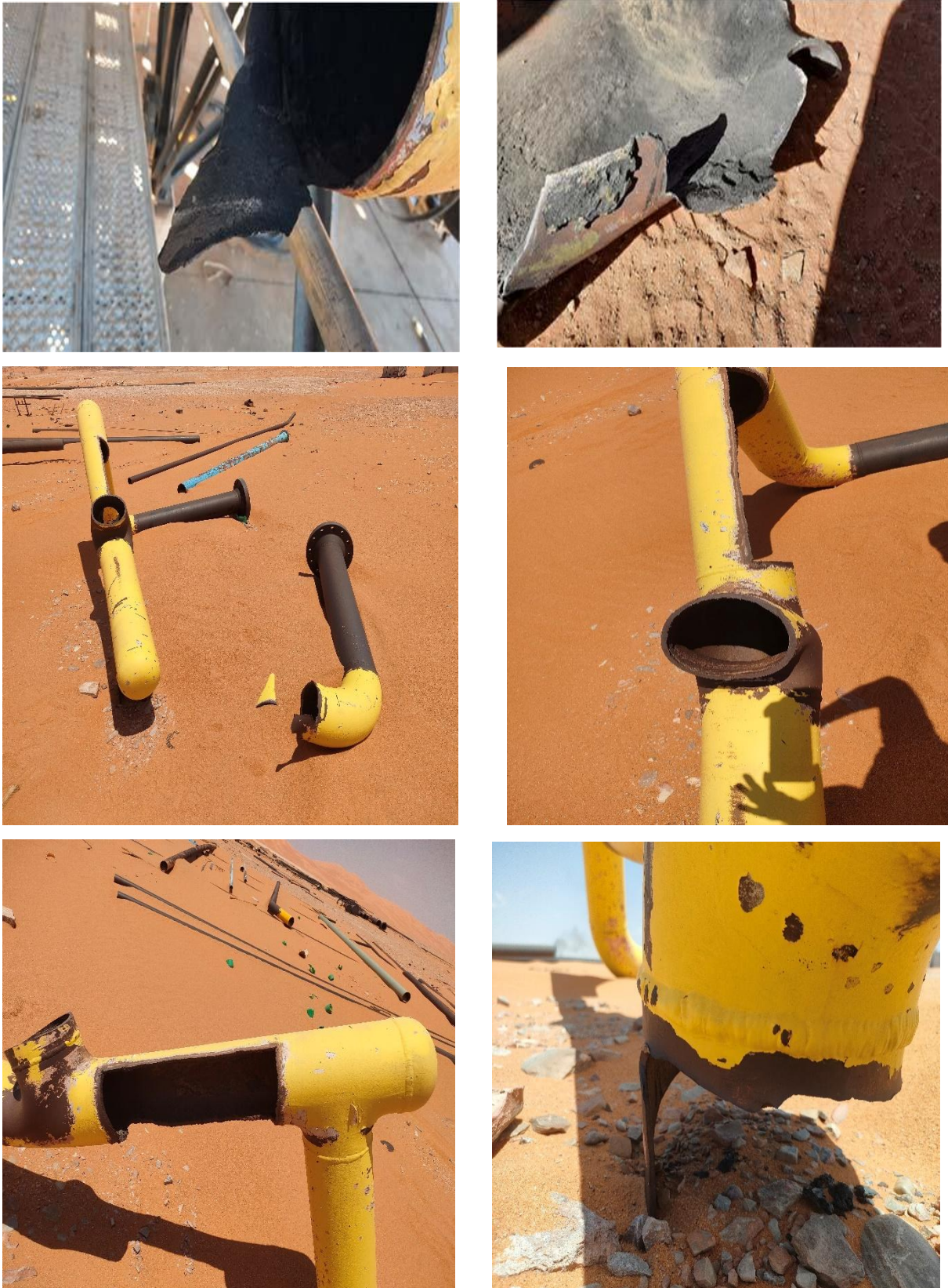
Figure 37. État de manchette après la sinistrée.
