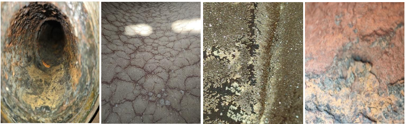
Figure 20. Différents types de corrosion observés dans les conduites d'installation
