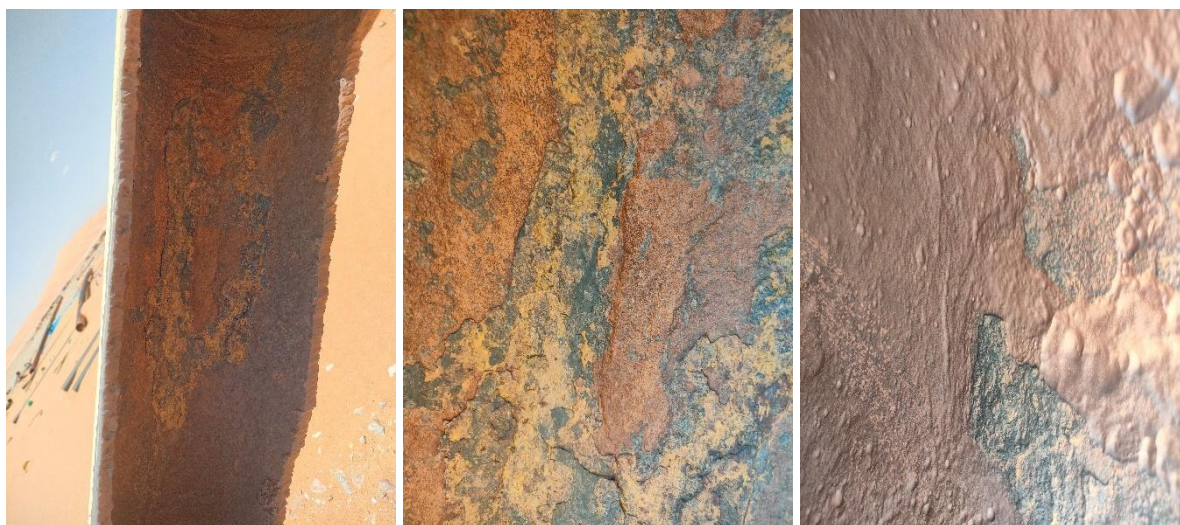
Figure 23. Corrosion bactérienne observée à l'intérieur de la conduite
