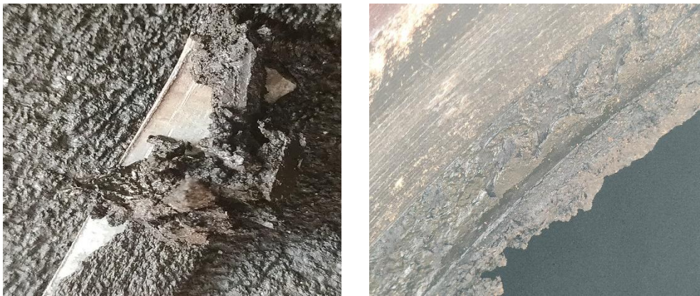
Figure 21. Incrustations de paraffine à l'intérieur d'une conduite
