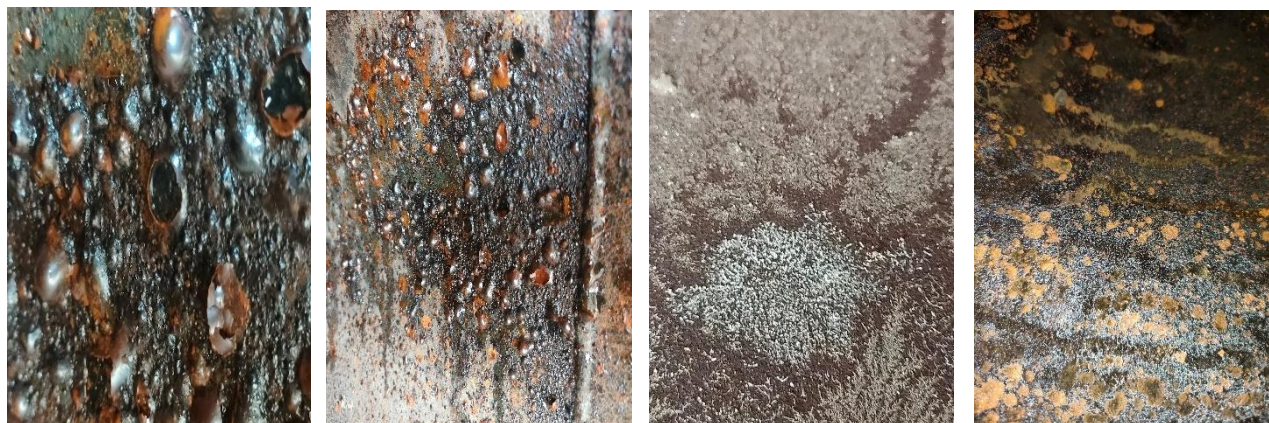
Figure 22. Corrosion chimique (humide) observée à l'intérieur de la conduite
