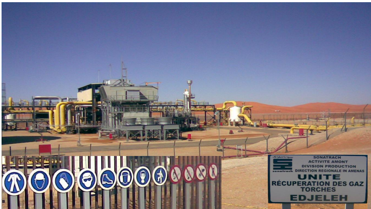
Figure 1. Vue générale de l'unité RGTE
