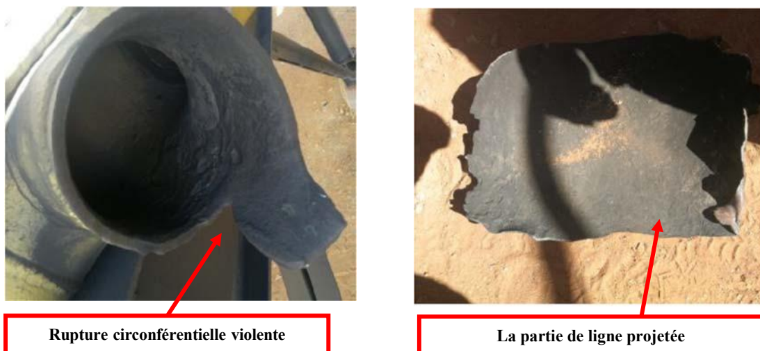
Figure 15. Types de ruptures observées sur le tronçon, (circumférentielle et longitudinale)
