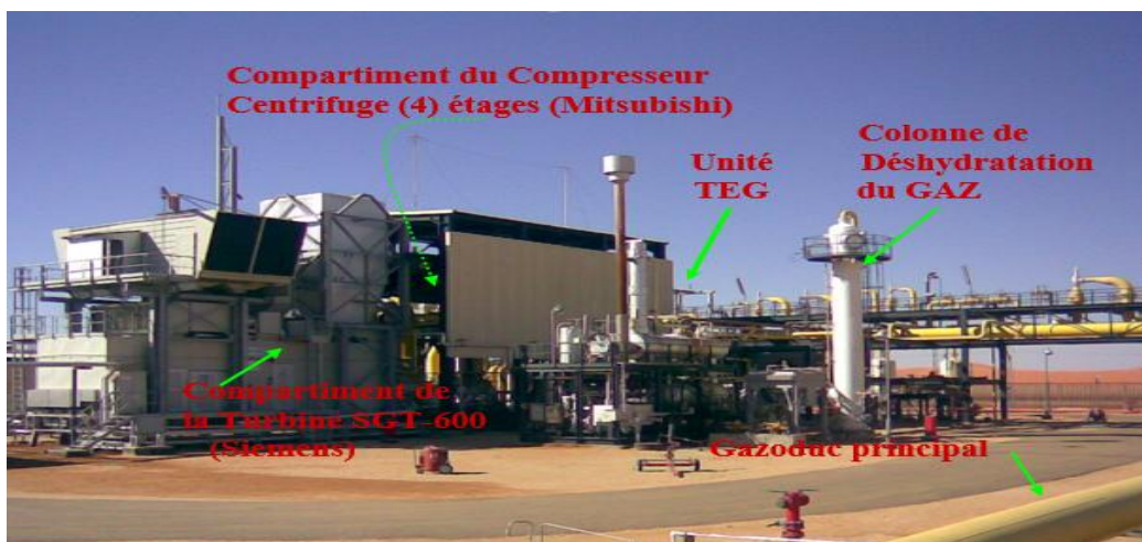
Figure 3. Les équipements de station de compression RGTE
