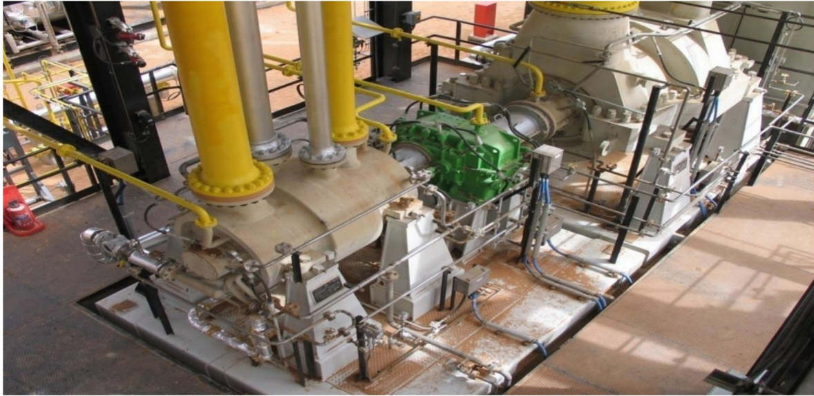
Figure 5. Compresseurs centrifuge Mitsubishi 20-K-001 à Quatre étages
