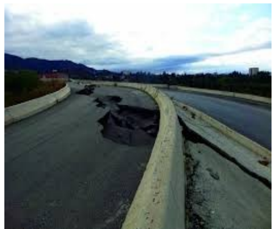
Figure I-5 : Dégradation de chaussée [f-5]
