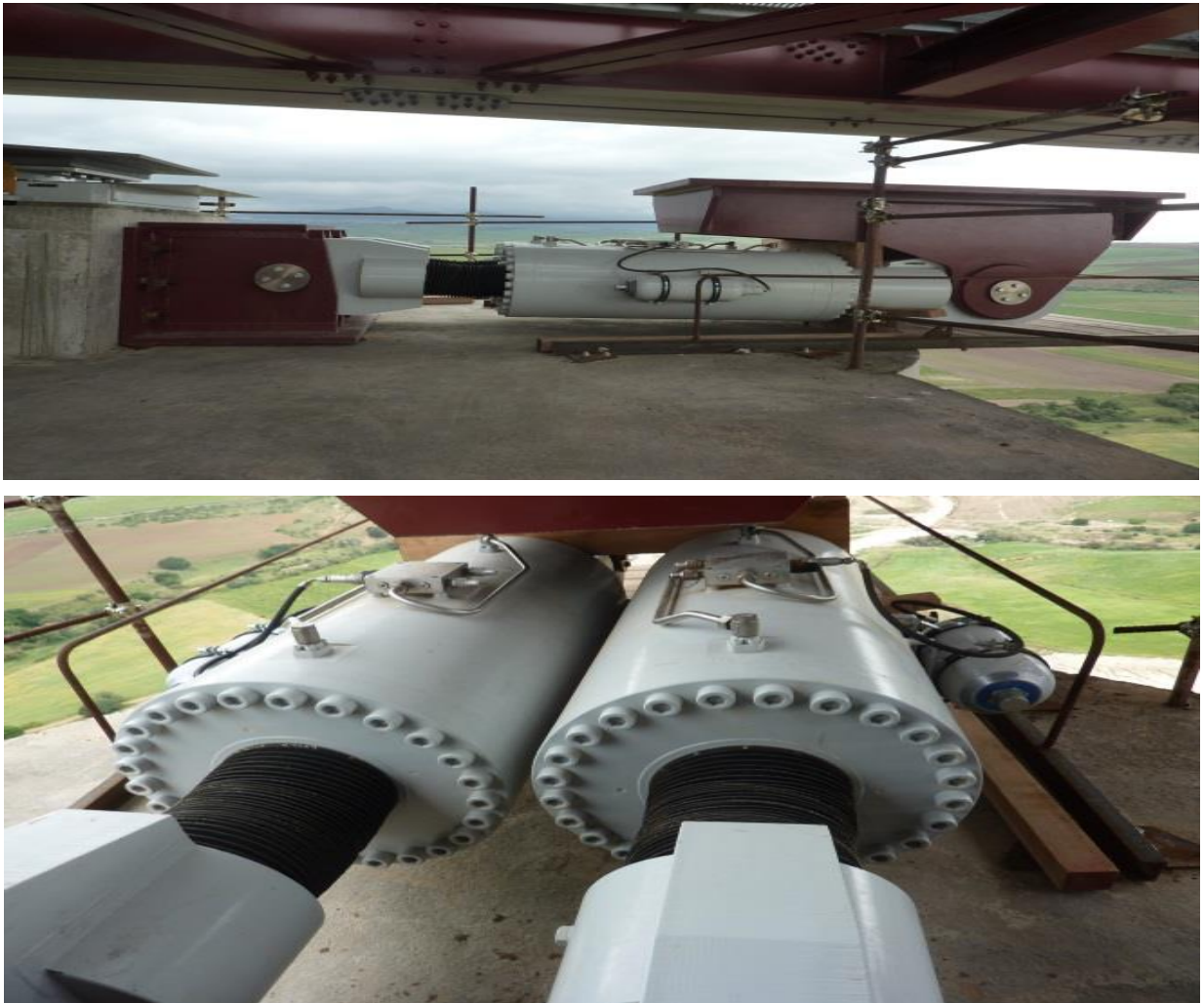
Figure 3.2 : FVD utilisé dans la ligne ferroviaire Oued Tlilet-Tlemcen.
