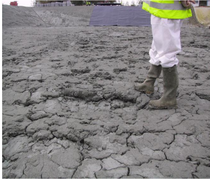
Figure II. 9: Exemple de surface de barrière minérale compactée de façon inappropriée (Cartaud. F, 2004)
