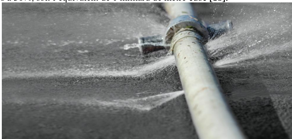
Figure I.12 : un cas de fuite de réseau de distribution [19].
