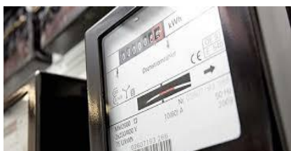
Figure 167: compteur; Source : https://www.google.com
