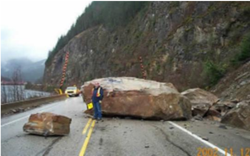
Figure 1-4 : Phénomène d'éboulement rocheux sur un talus instable
