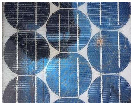
Fig. 1.14 : Module photovoltaïque présentant des bris de verre.
