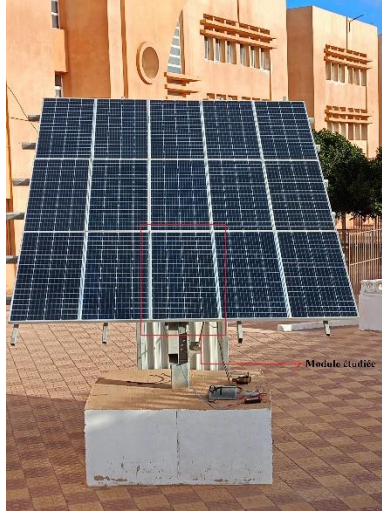
Fig.2.3 : Le module photovoltaïque usagé.
