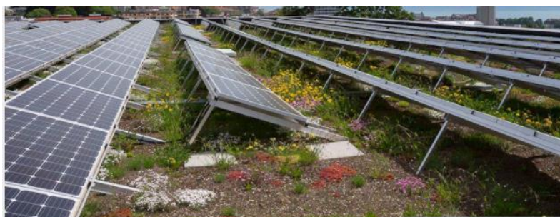
Figure 78 : Panneaux solaires sur toiture végétalisée
