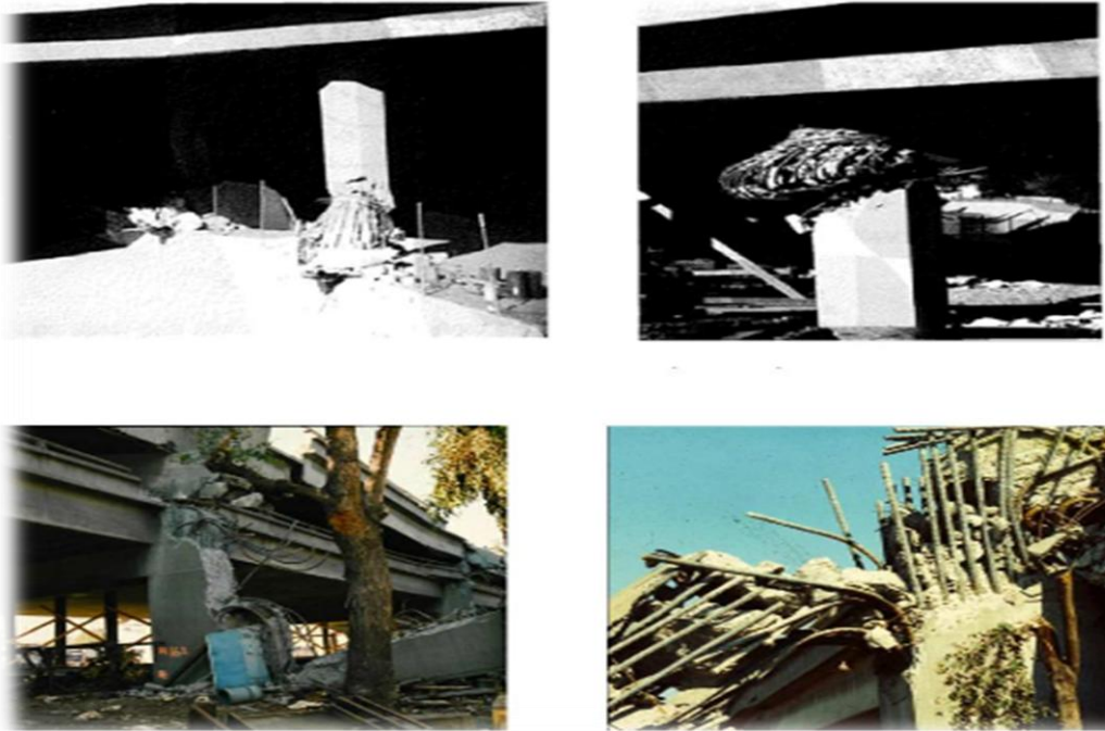
Fig.1.13: Pont 118/Bull Creek, Séisme de Northridge -Los Angeles 1994 [4]
