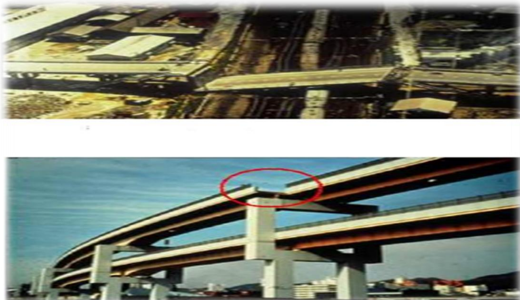
Fig.1.10 : Déplacements et effondrements des tabliers lors des séismes de Niigata 1964 et Kobé 1995[3].
