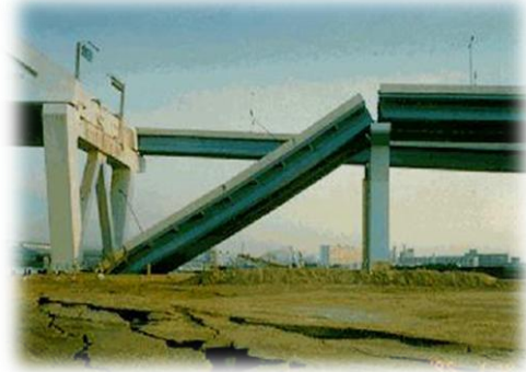
Fig.1.4 : effondrement d'une travée du pont de Nishinomya-ko en 1995 suite au séisme de Nandu[12].
