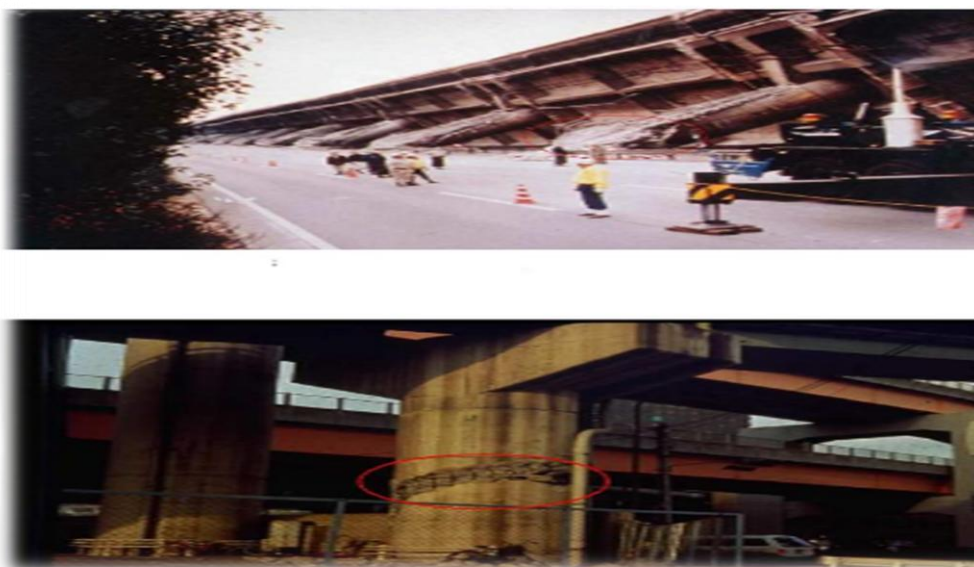
Fig.1.14 : Endommagement des piles lors du séisme de Kobé 1995 [3].
