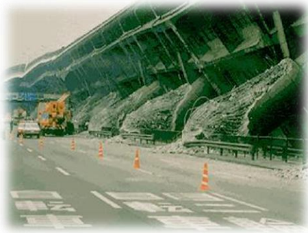
Fig.1.3 : effondrement du viaduc De Higashi-nada en 1995 suite au Séisme de Nanbu[12].
