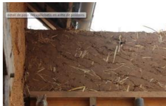
Figure 1.21 amélioration à la fissuration
