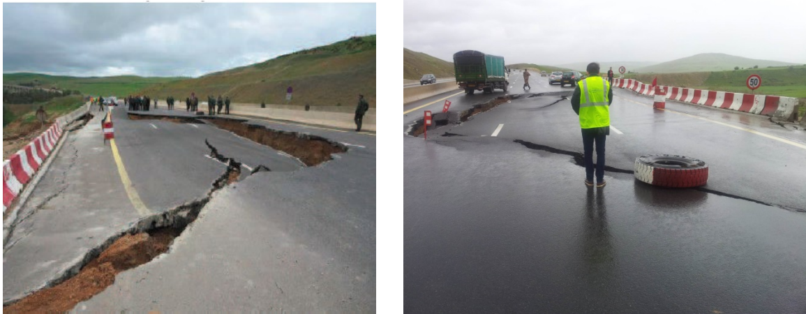
figure 5.1 : Déformation du corps de chaussée au point kilométrique PK 52 (Tlemcen)
