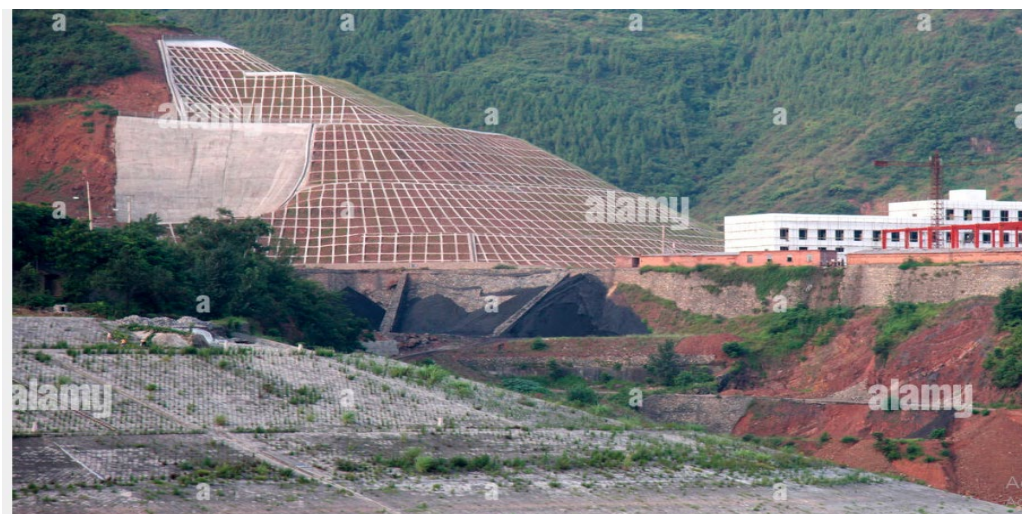
figure 1.15 : Système de protection contre les chutes de pierres
