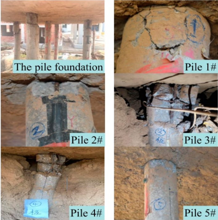
figure 3.21 : Etat du groupe de pieux dans le sol moyennement dense, après chargement sol
