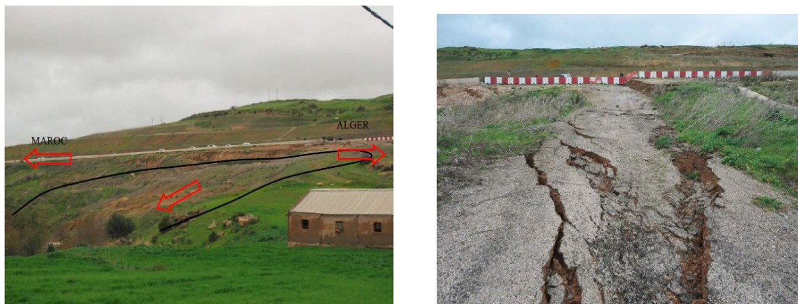
figure 5.2 : Vue générale du glissement ainsi que sa limite latérale
