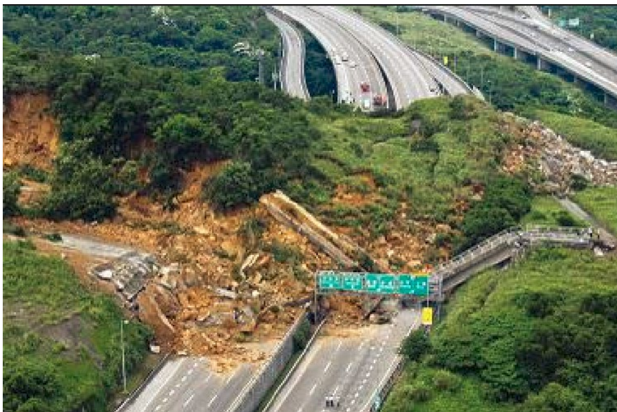
figure 1.1 : Effondrement de l'autoroute No3 à Taïwan en 2010
