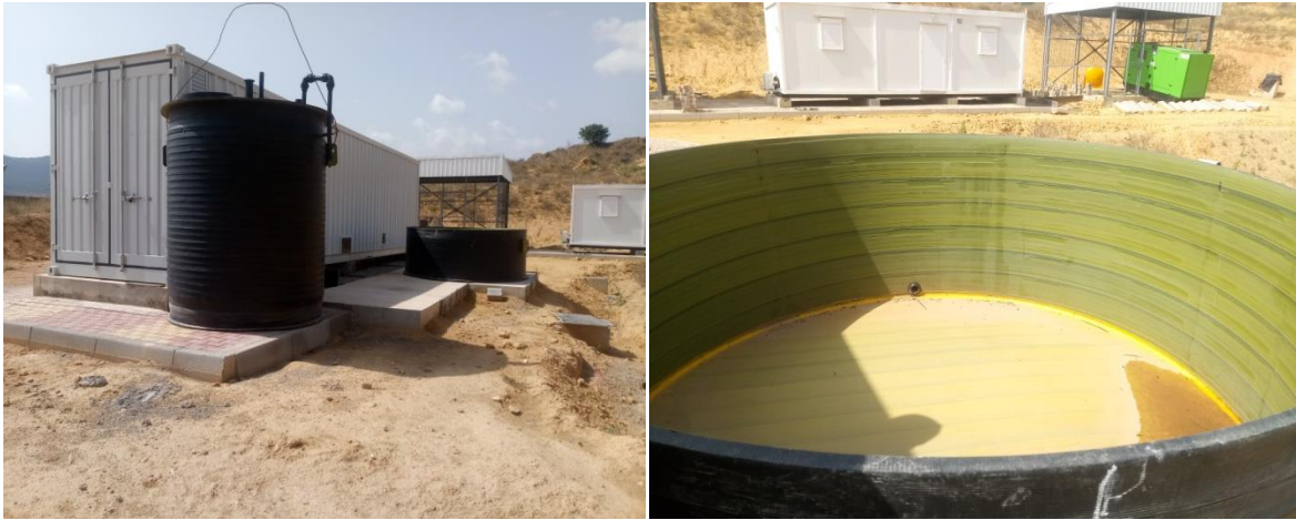
Figure 0-10: Équipement de traitement de lixiviat (J'ai pris des photos)
