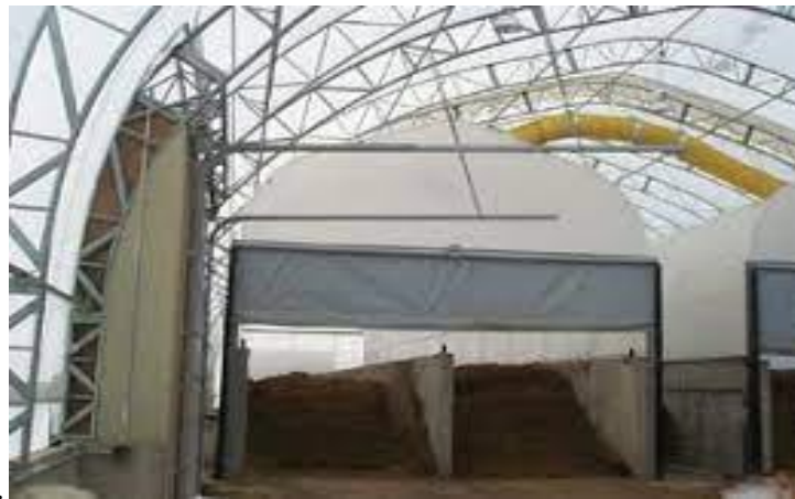
Figure 0-13: Système de compostage en silos-couloirs
