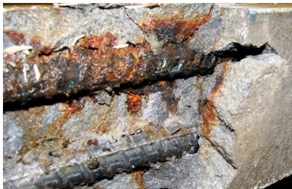
Figure 6: corrosion des aciers avec éclatements de béton dus au manque d'enrobage des armatures [61].
