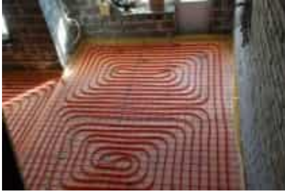
Figure 92 : Les émetteurs de Chaleur
