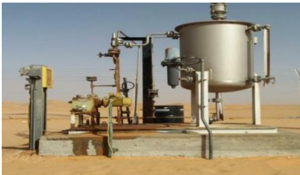
Figure 2. Unité de pompage d'inhibiteur.
