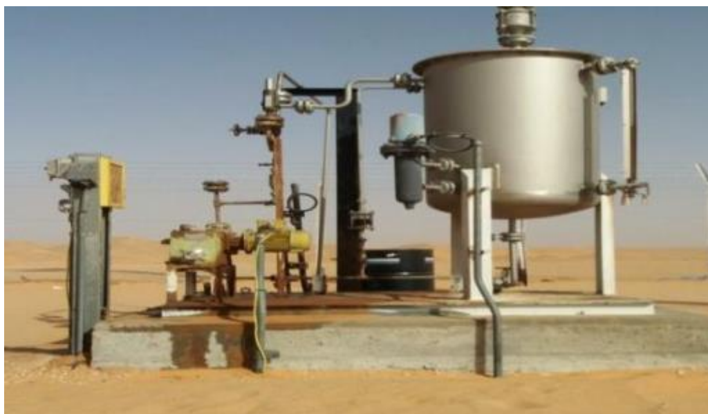
Figure 2. Unité de pompage d'inhibiteur
