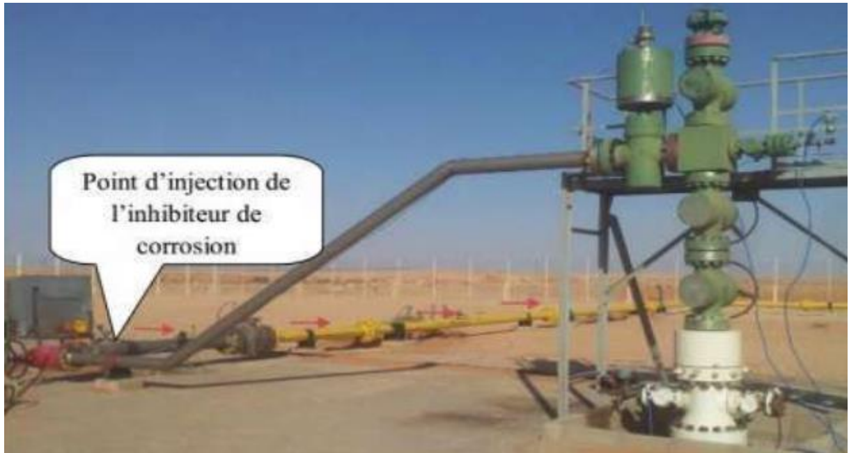
Figure 3. Point d'injection de l'inhibiteur de corrosion au niveau du puits.
