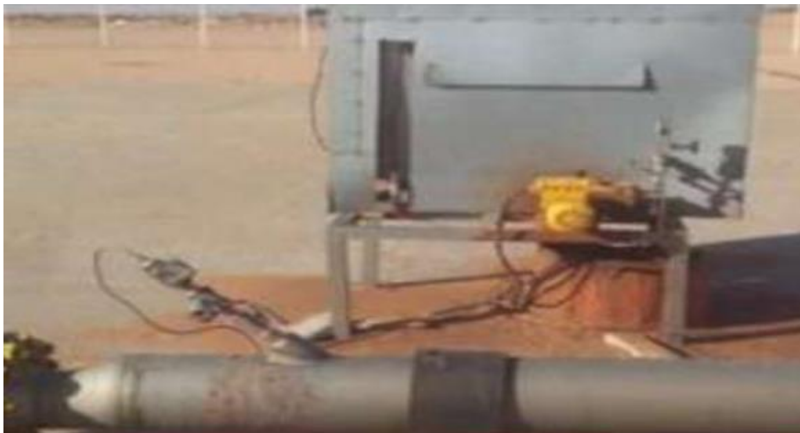
Figure 4. Pompe doseuse responsable à injecter l'inhibiteur de corrosion.
