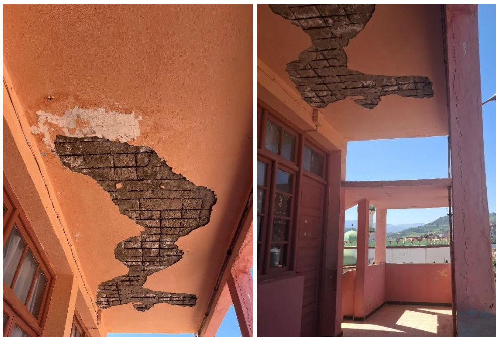
Figure 4. 14: effondrement partiel du plafond avec armatures apparentes au premier étage [43]
