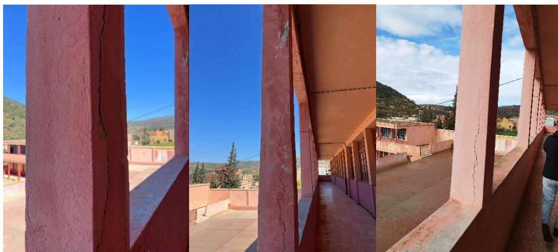
Figure 4. 15: Fissurations des poteaux courts au premier étage du bloc D [43]
