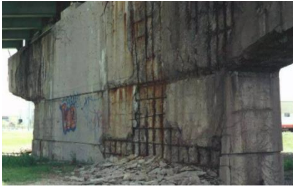
Figure 1. 21: dégradation du béton sous l'action des chlorures [12]
