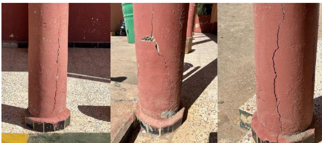
Figure 4. 9: fissurations du béton au niveau des poteaux [43]
