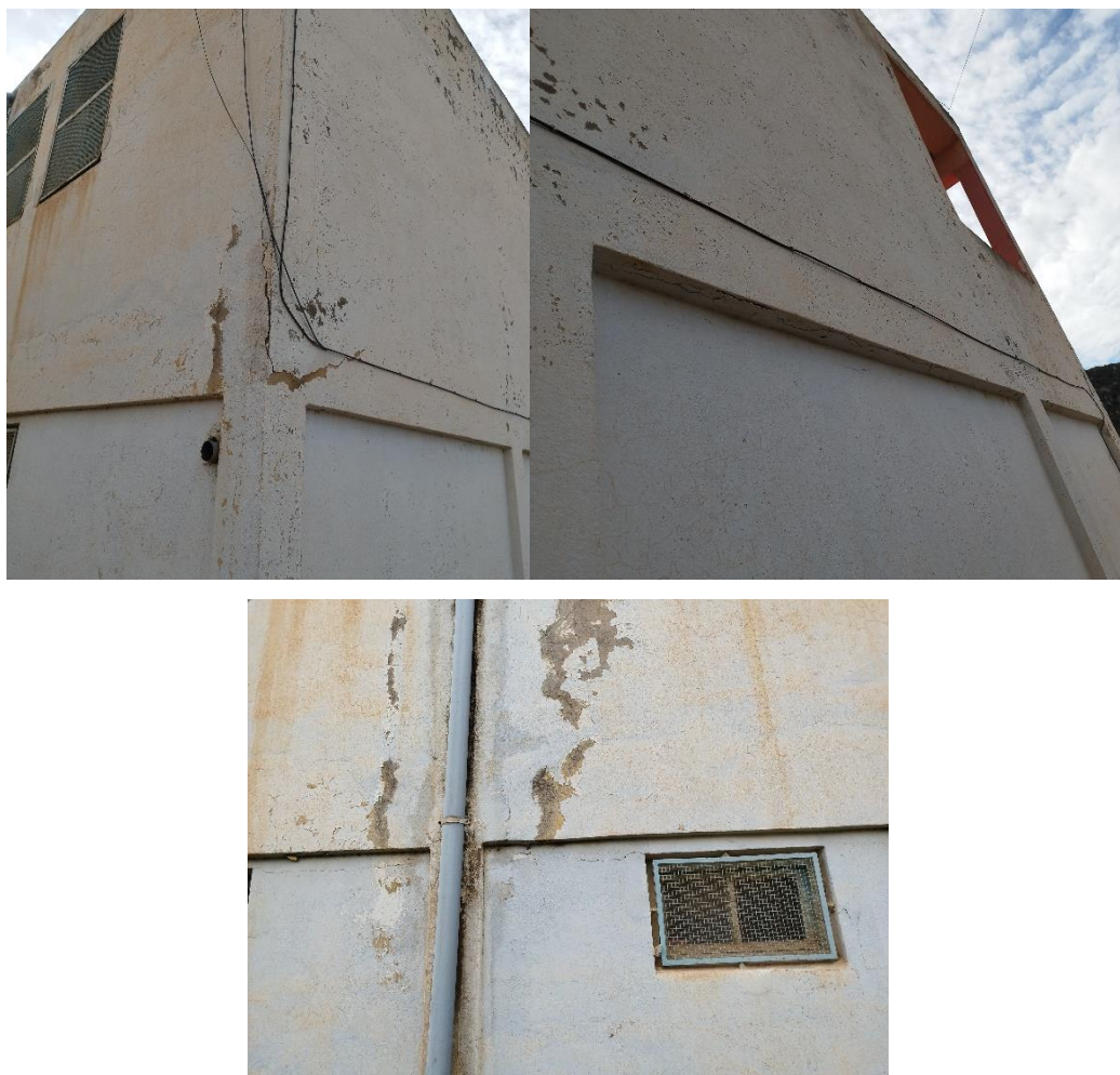
Figure 4. 22: dégradations sur les murs extérieurs de l'école [43]
