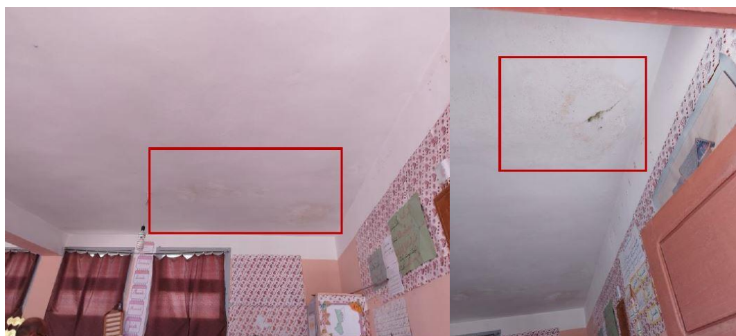
Figure 4. 13: traces d'humidité observées au niveau du plafond du bloc C [43]
