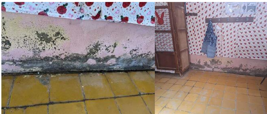
Figure 4. 10: gonflement du revêtement de sol dû aux infiltrations d'eau [43]
