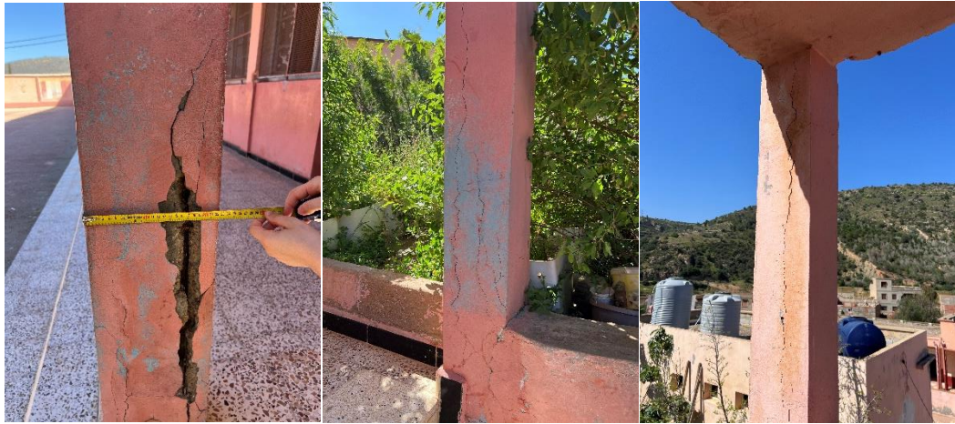
Figure 4. 16: éclatement du béton et mise à nu des armatures des poteaux de la cage d'escalier [43]
