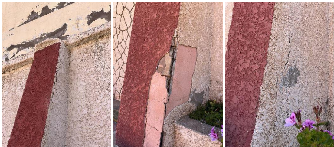
Figure 4. 20: dégradation des contreforts avec fissuration et éclatement de l'enrobage [43]
