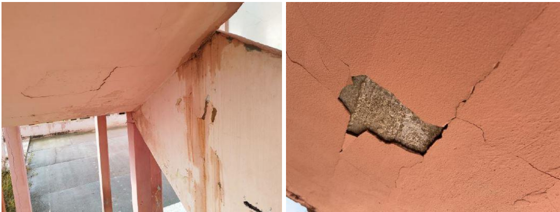
Figure 4. 17: dégradations liées à l'humidité et décollement de l'enduit dans la cage d'escalier [43]
