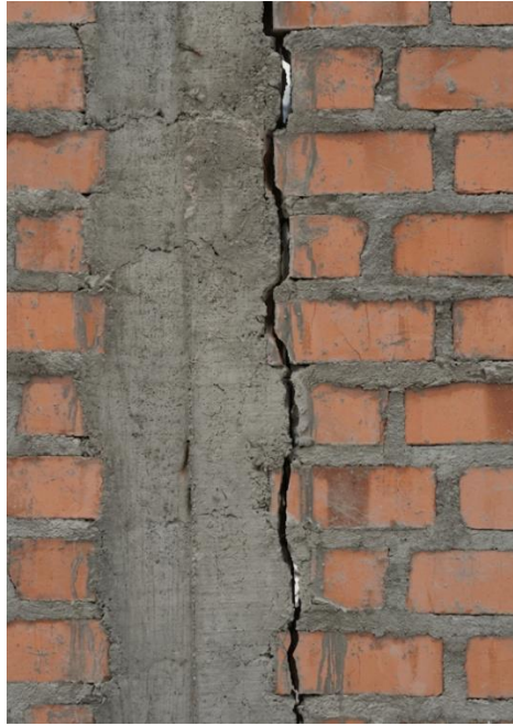
Figure 1. 13: une fissure verticale nette au joint entre un poteau en béton armé et un mur de maçonnerie en briques [39]
