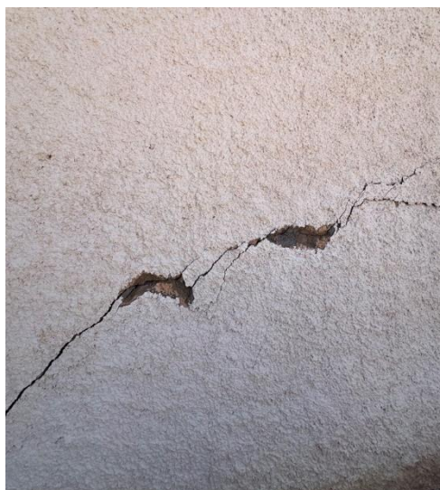
Figure 1. 8: lézarde, bâtiment administratif, chetouane [36]
