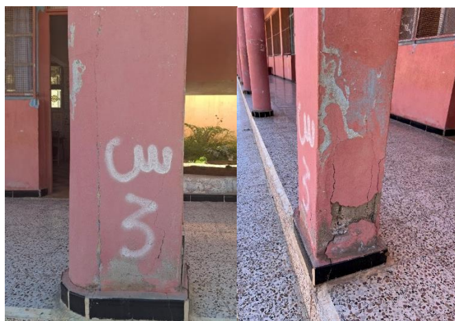
Figure 4. 21: dégradation d'un poteau à section hybride [43]
