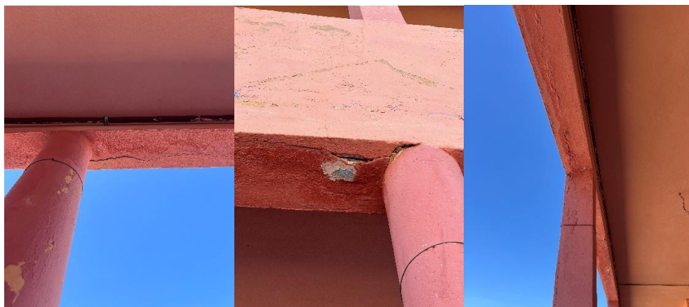
Figure 4. 12: fissurations longitudinales de poutres en béton armé induites par la corrosion des armatures Bloc C [43]
