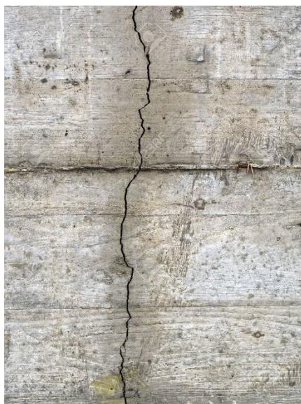
Figure 1. 3: fissure verticale dans un mur en béton armé [28]
