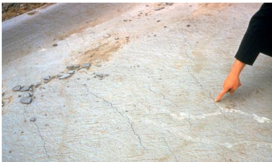
Figure 1. 9: illustration des fissures dues au retrait plastique du béton [37]
