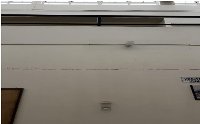
Figure 1. 4: fissure horizontale, bâtiment administratif, chetouane [36]
