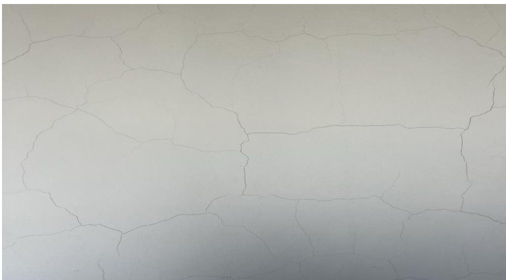
Figure 1. 2: faïençage dans un enduit de façade d'un bloc administratif [42]
