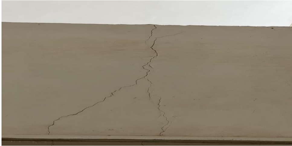
Figure 1.1: une fissure affecte une poutre en béton armé, bâtiment administratif chetouane [36]
