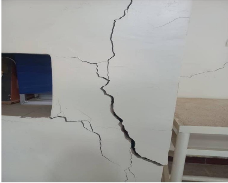
Figure 1. 7: fissure traversante, bâtiment administratif, chetouane [34]
