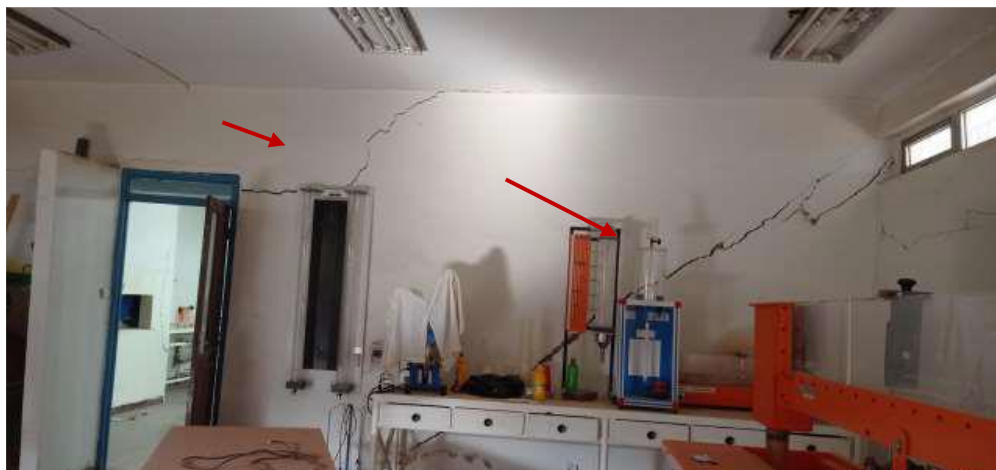
Figure 1. 16: Exemple de fissuration diagonale ( 45^\circ ) relevée au niveau des murs d'un laboratoire au l'université de Tlemcen [34]
