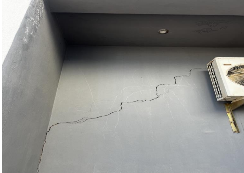
Figure 1. 5: fissure en escalier dans un mur de façade bâtiment administratif, chetouane [36]
