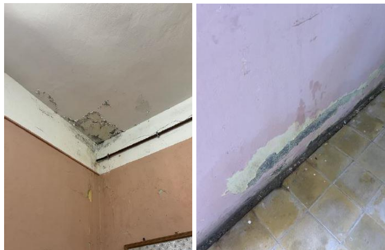
Figure 4. 7: pathologies liées à l'humidité - traces au plafond de la partie A2 et remontées capillaires en partie inférieure de mur d'ancienne cantine [43]
