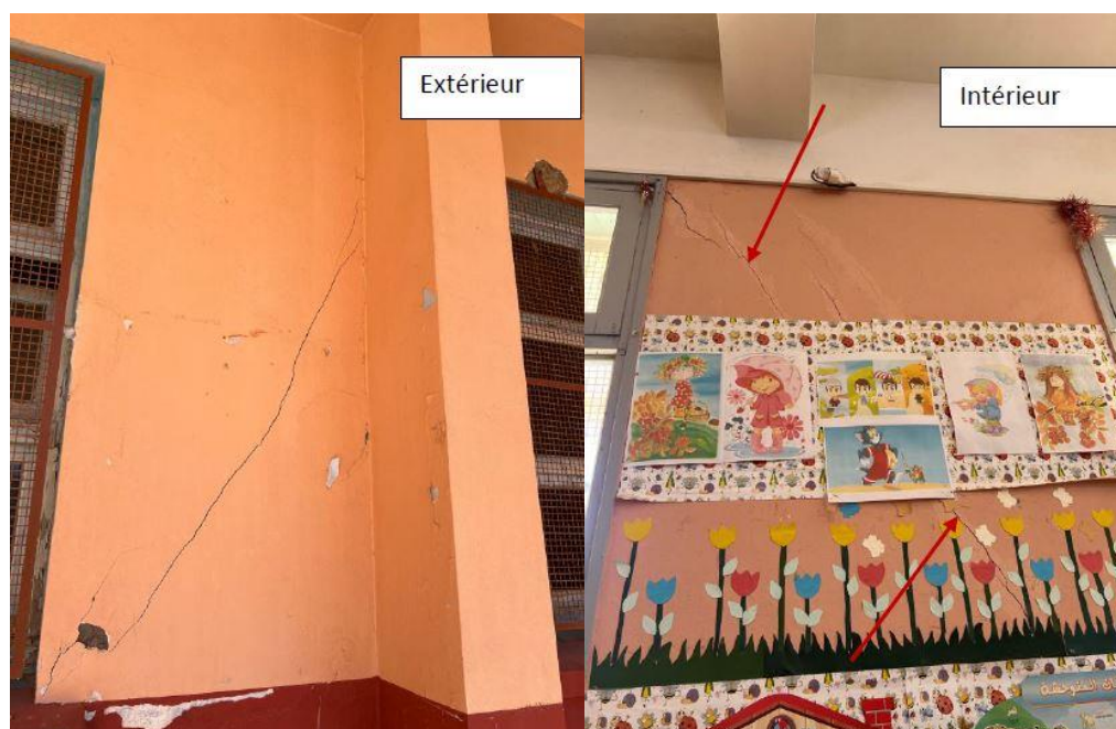
Figure 4. 8: fissures diagonales visibles sur les deux faces du mur [43]
