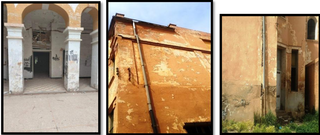
Figure 45 L'eau infiltrée dans les murs 47
