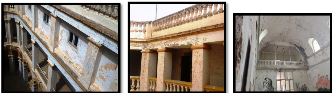
Figure 48 . La présence de fractures horizontales
