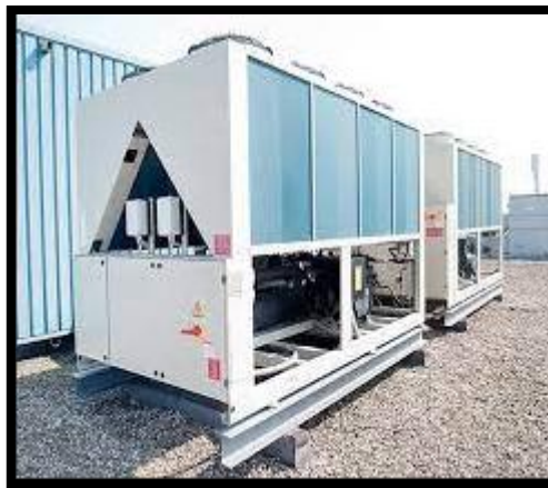
Figure 89. système de climatisation à base de l'eau glacée. Source site web
