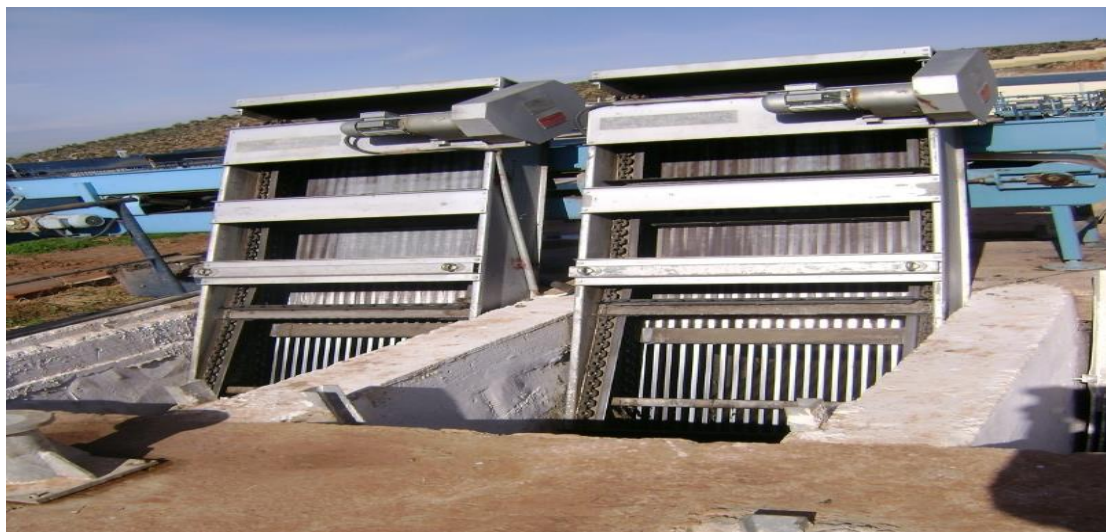
Figure 26: Grille mécanisée (2 unités)
