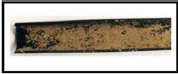
Figure 7: Dépôt de MES dans une conduite d'irrigation (Razi,M, 2012)
