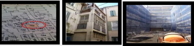
Situation de l'îlot Verlaque Habitat dégradé de l'îlot Verlaque Phase de démolition
