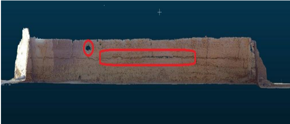
Figure 41 : Fissure au niveau des murs
