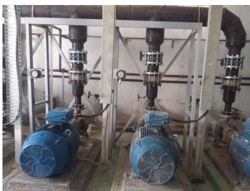
Fig. 46 Photo de pompe haute pression
