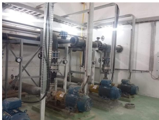
Fig. 42 Photo de la pompe de gavage
