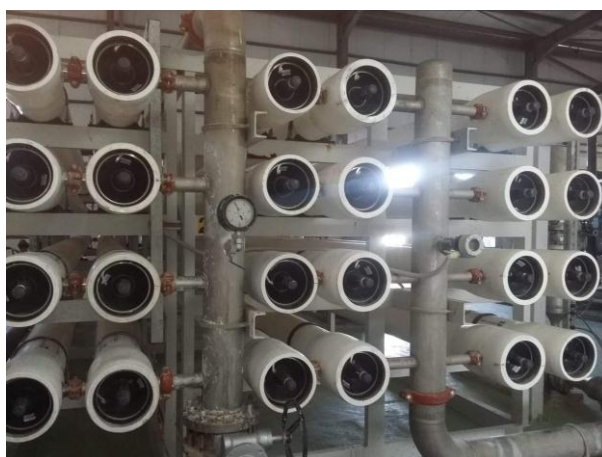
Fig. 48 Photo d'un étage d'osmose inverse
