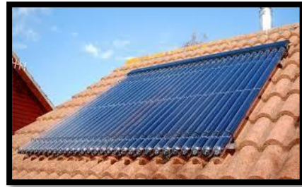
Figure 205:panneaux solaires thermiques
