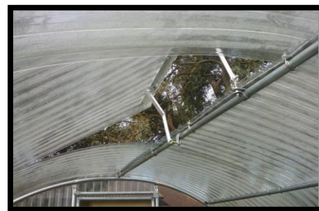
Figure 102 : Aération des serres ,
